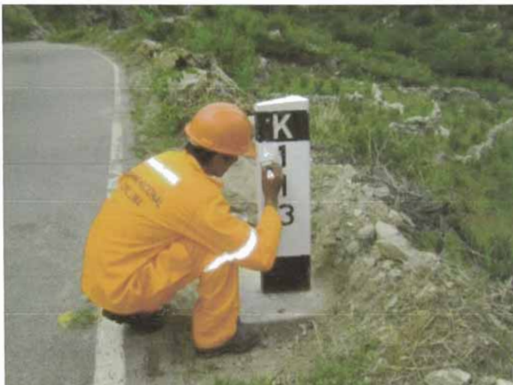
Figura N°2.6: Conservación de marcas en el pavimento y postes kilométricos
