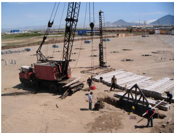
Fotografía N° 7: Vista panorámica del montaje del equipo hidráulico.
