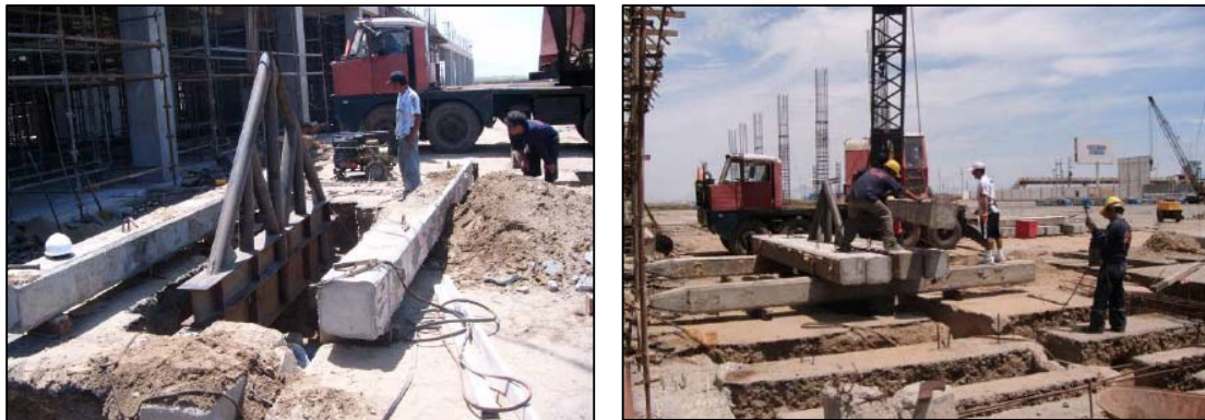
Figura 4.16: Vista de Sistema de Reacción de PCE - Chimbote
