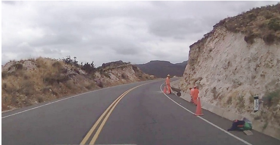
Figura 2.16: Obreros de Conservación Vial expuestos a riesgo.
