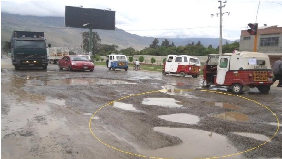
Figura 2.9: Superficie de rodadura deteriorada.
