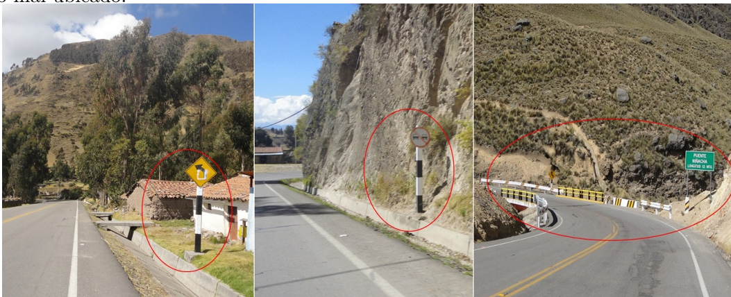
Figura 2.11: Señalización vertical preventiva rayada, reglamentaria desgastada, e informativo mal ubicado.
