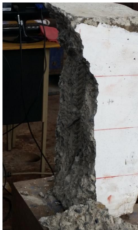
Foto 15: Excesivo recubrimiento suministrado en el apoyo de VF-03.
