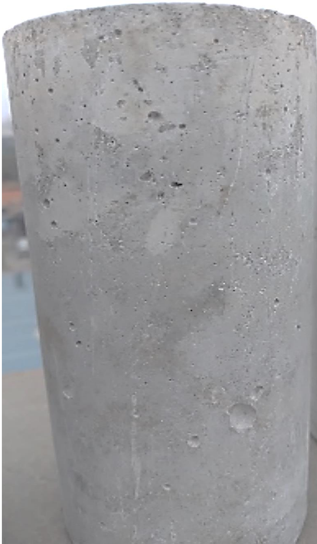
Figura N°27 Picaduras en concreto simple
