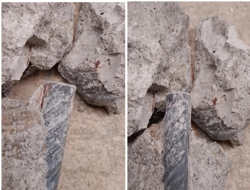
Figura N°31 Productos de corrosión en la barra de refuerzo
