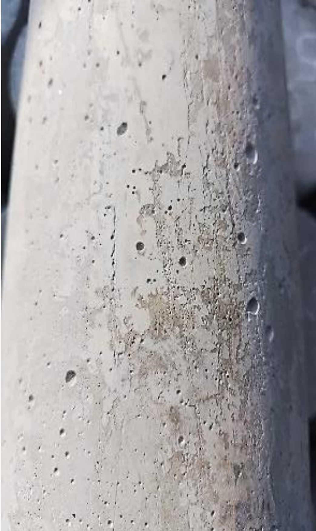
Figura N°28 Desprendimiento superficial en concreto armado
