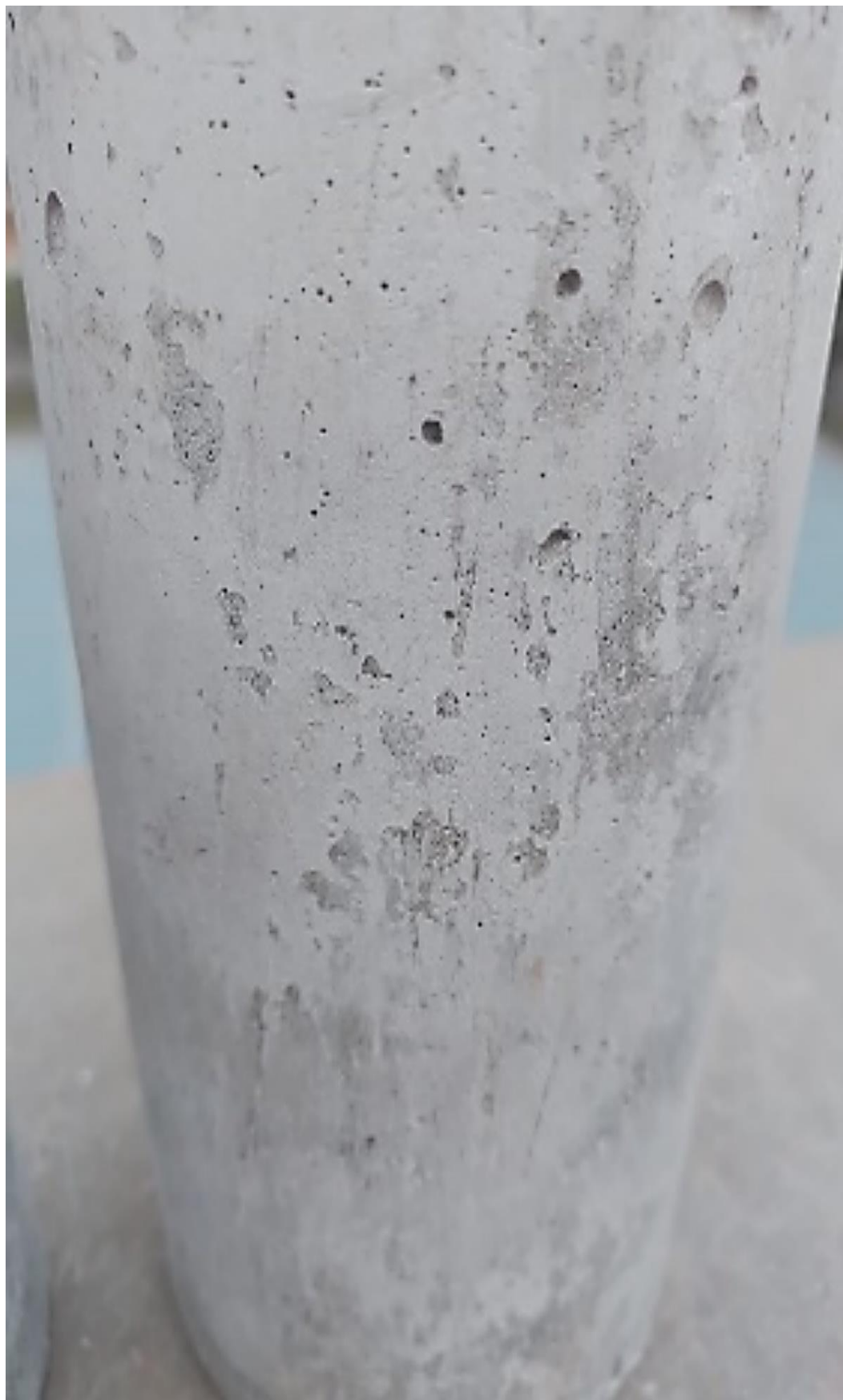
Figura N°26 Desprendimiento superficial en concreto simple
