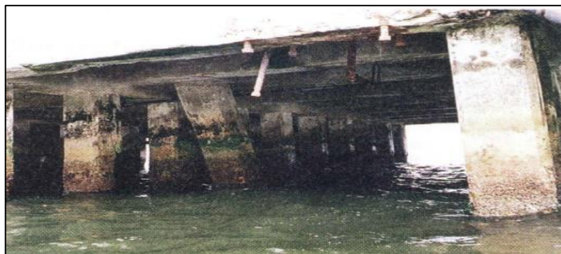
Figura N°4 Corrosión de estructura de concreto armado Representación Fuente: Gonzáles de la Cotera (1998)
