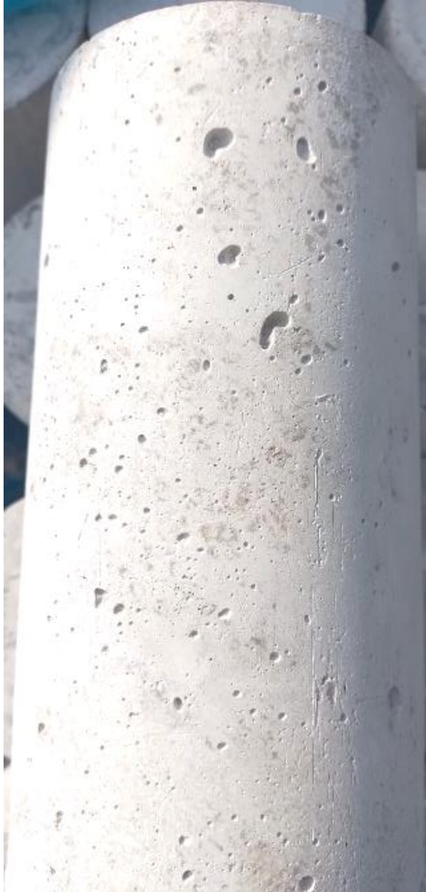
Figura N°30 Picaduras en concreto armado
