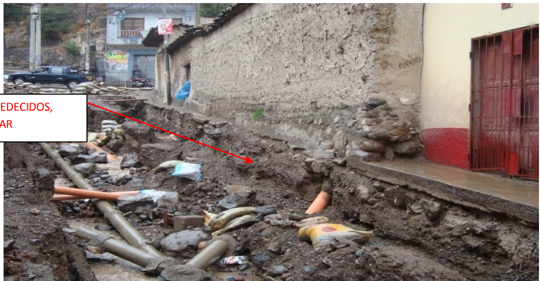
Foto N° 08: Cimentación en peligro de colapso
