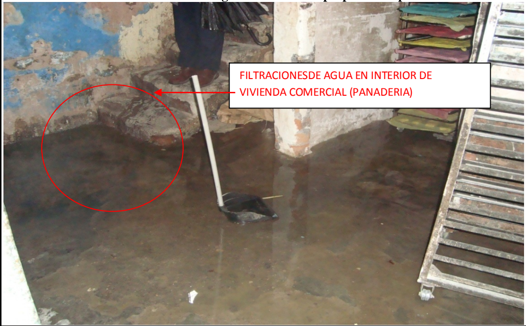
Foto N°. 06 Filtraciones de aguas de lluvias en propiedades particulares.
