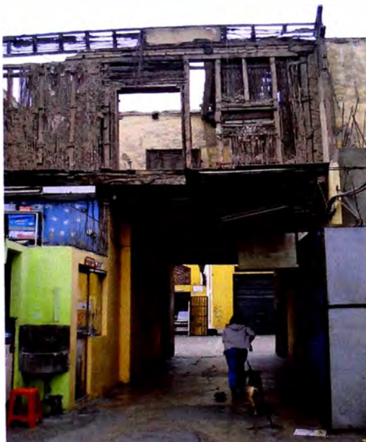
Foto 2: Vista posterior de la edificación en ruinas
