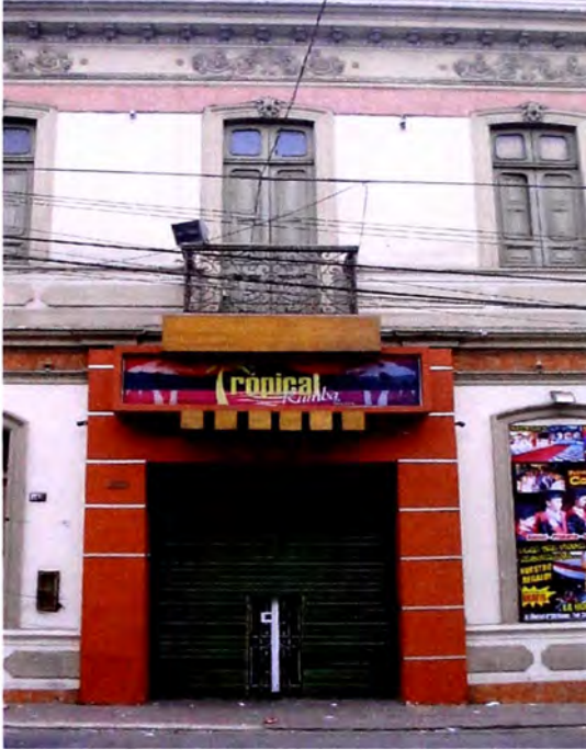
Foto 1: Local con vano modificado, sin pilastras.
