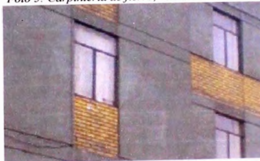
Foto 5: Carpintería de fierro, ventanas.
