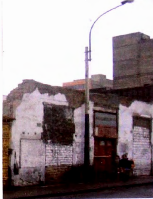
Foto 5: Sección con puerta y vanos clausurados.
