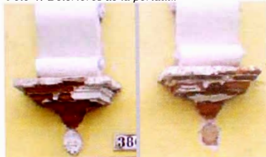
Foto 4: Deterioros de la portada.
