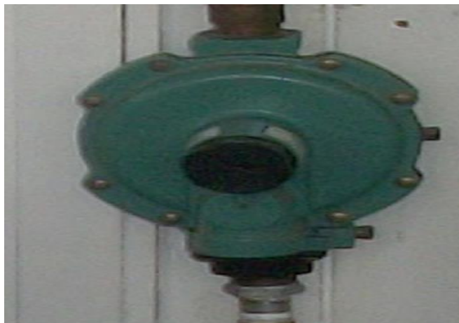
Fig. 7.10 Regulador de baja presión Marca FISHER
