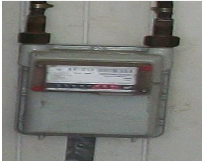
Fig. 7.8 Medidor de baja presión Marca ELSTER AMCO
