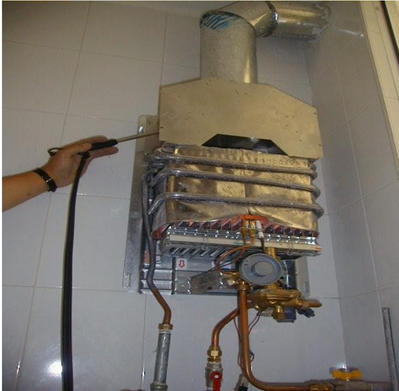
Fig. 2.8 tomando la prueba de CO de un calentador de agua
