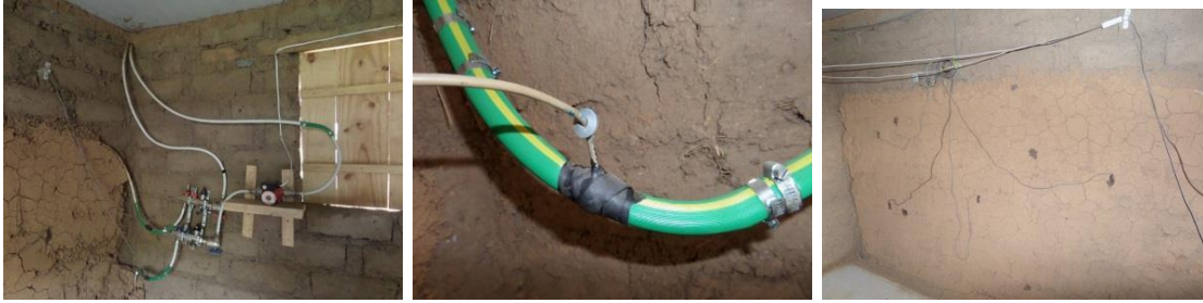
Figura 4.2.6. A la izquierda, se observa el distribuidor de flujo con las tuberías de llegada y retorno de agua del y al colector, así como las de entrada y salida del serpentín que aparecen con una porción de color verde cuyo detalle se observa en la fotografía del medio, esta porción es un trozo de manguera que se instaló para montar en él el sensor que mide la temperatura del agua en el interior de la tubería, a la entrada y a la salida del serpentín; originalmente se había instalado estos dos sensores haciendo un orificio sobre la tubería del circuito, cosa que no dio resultado por la imposibilidad de evitar el goteo del agua. La imagen de la derecha deja ver la posición de sensores sub superficiales en el muro que porta al serpentín, en posiciones aproximadas al inicio medio y final del serpentín.
