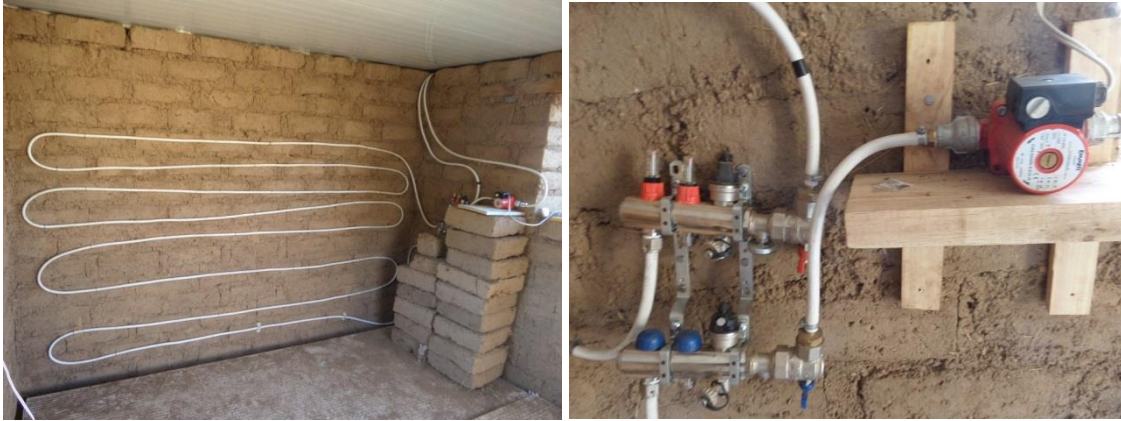
Figura 3.3.4. A la izquierda, se ve el serpentín sobre el muro antes de ser cubierto con una capa de 2-3 cm de barro; a la derecha, el distribuidor de flujo.
