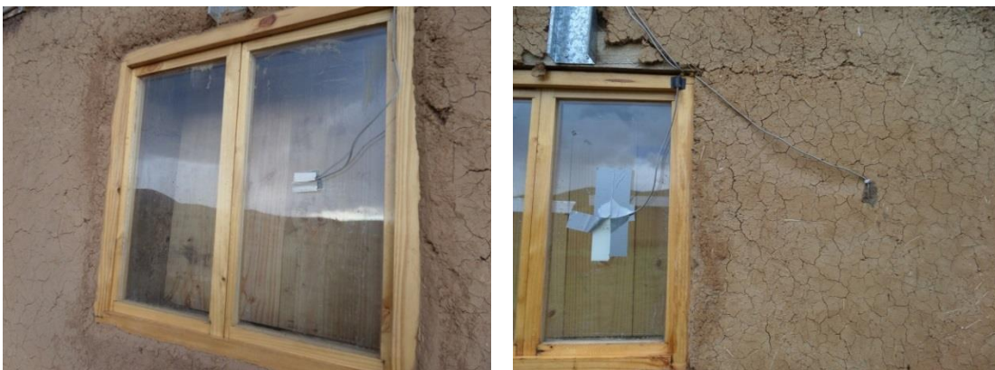
Figura 4.2.5. A la izquierda, se muestra la posición de un sensor que medirá la temperatura de la superficie exterior del vidrio de la ventana en contacto con el ambiente exterior, de forma similar se montó un sensor sobre la superficie del vidrio interior en contacto con el ambiente interior; la imagen de la derecha muestra el sensor montado sobre otra ventana y, además, un sensor sobre la superficie exterior de un muro.
