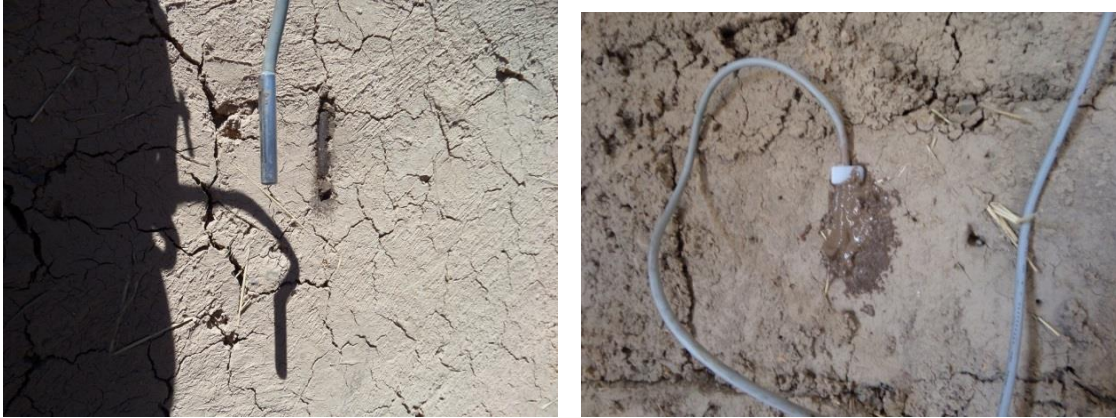
Figura 4.2.4. Fotografías que ilustran el montaje de un sensor que medirá la temperatura superficial exterior del muro, antes de colocarlo en la cavidad preparada para albergarlo y después de haberlo hecho, cubierto con una mezcla de barro más cola para pegar madera. Esta capa de barro que cubre y protege al sensor es de 0,002 a 0,0033m de espesor a fin de lograr valores de la temperatura con mayor fidelidad.
