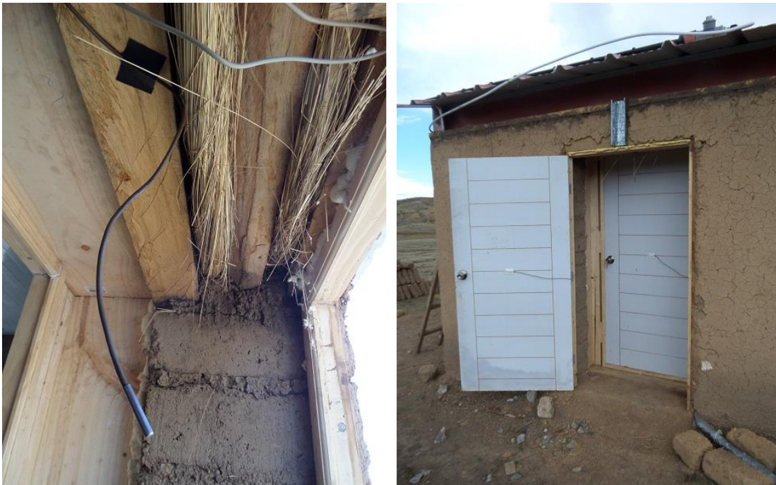
Figura 4.2.7 A la izquierda, se observa el sensor que mide la temperatura del aire en el interior de la esclusa. A la derecha, se muestra los sensores instalados sobre las superficies de la puerta exterior (en posición abierta) e interior (en posición cerrada); se instaló sensores en ambas caras de cada una de las 4 puertas (2 puertas orientadas al norte y 2 puertas orientadas al sur).
