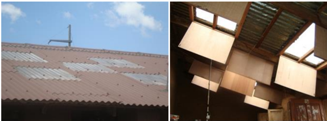
Figura 2.3.1. Ventanas térmicas en techo; a la izquierda imagen de la superficie exterior del techo, a la derecha imagen de la superficie interior del techo en la que se observa las puertas de protección nocturna.
