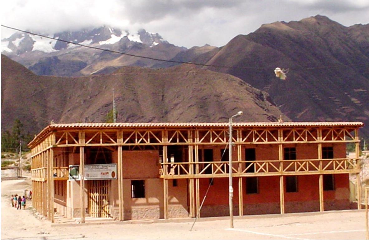
Figura 1.3.6. La vista muestra la estructura de dos plantas del Centro, aún sin acabar, prevista para lograr ventilación interior así como protección de soleamiento excesivo. El uso de materiales (madera, adobe) del lugar es otra característica importante de esta edificación.
