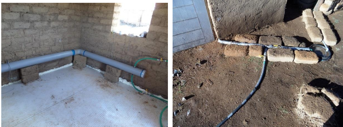
Figura 3.3.6. A la izquierda se muestra la imagen del tubo radiante en su posición final de montaje y funcionamiento, a la derecha se observa la tubería de desagüe.
