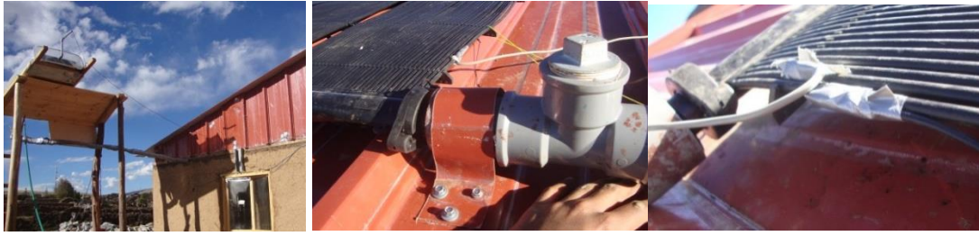
Figura 4.2.8. A la izquierda se puede notar en la imagen el cable que entra (o sale) de la tubería de rebose del colector tipo batea correspondiente al sensor usado para medir la temperatura del agua en su interior, al centro y a la derecha se observa sensores adheridos a la superficie exterior del colector solar.
