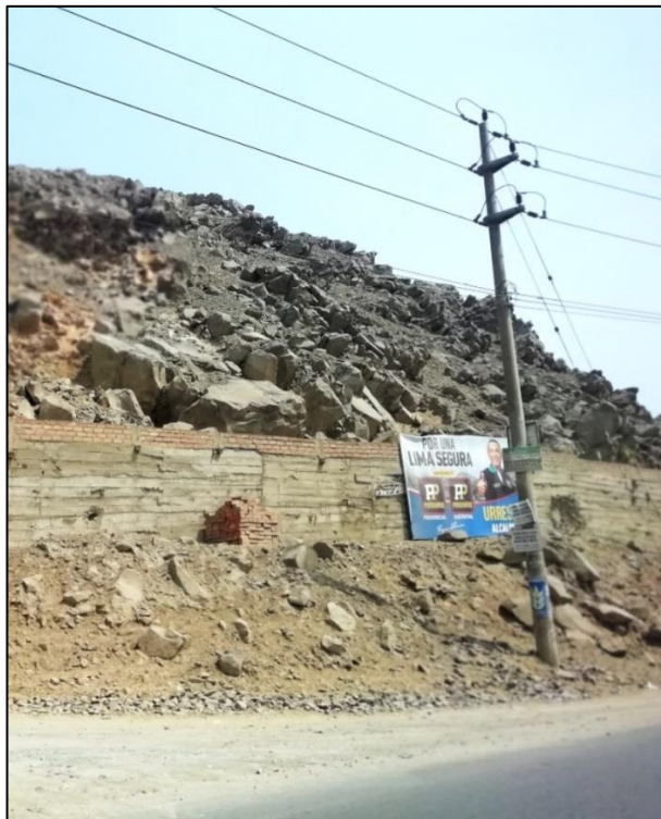
FOTO N ° 3.9: Peligro de rocas sueltas. Carretera Lima- Canta. Carabayllo (2018) Fuente: Elaboración propia
