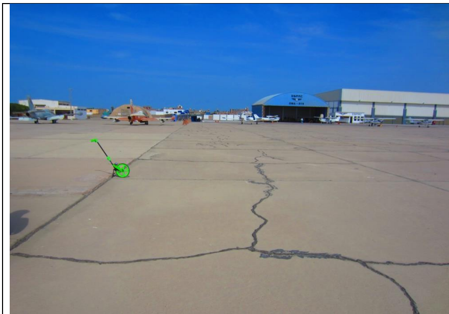
Foto N° 06: Medición con odómetro manual y relevamiento de fallas en la plataforma de estacionamiento antigua.
