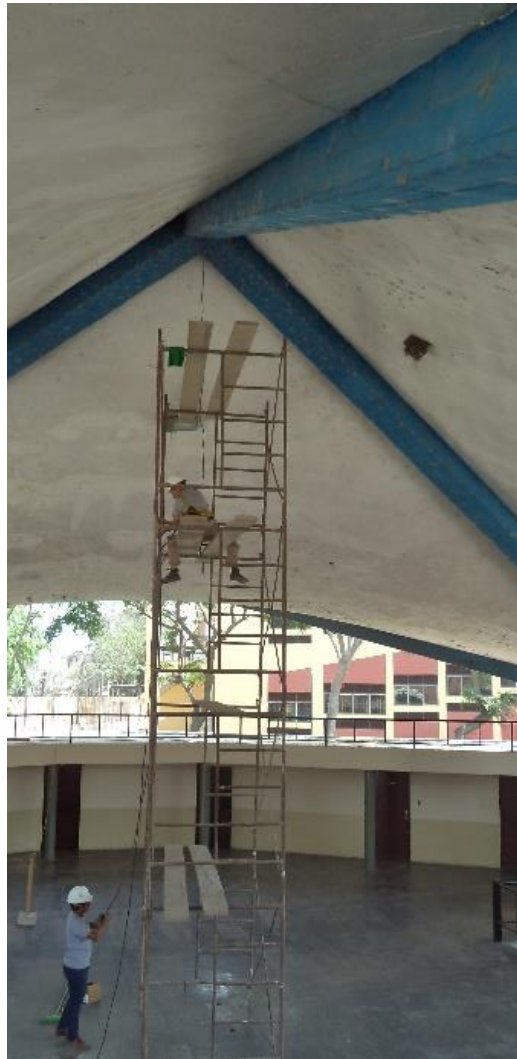
Figura N° E.1 Habilitación de andamios para la colocación de los sensores en los puntos en estudio seleccionados.
