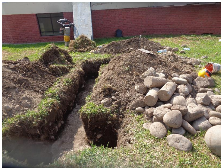
Figura N° 3.12 Auscultación de cimentación en el punto C de la subestructura del paraboloide hiperbólico FIC-UNI.
