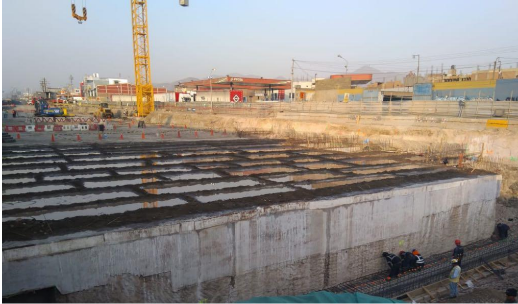
Foto 1. Proceso de curado de losa de hormigón en el nivel de cubierta.
