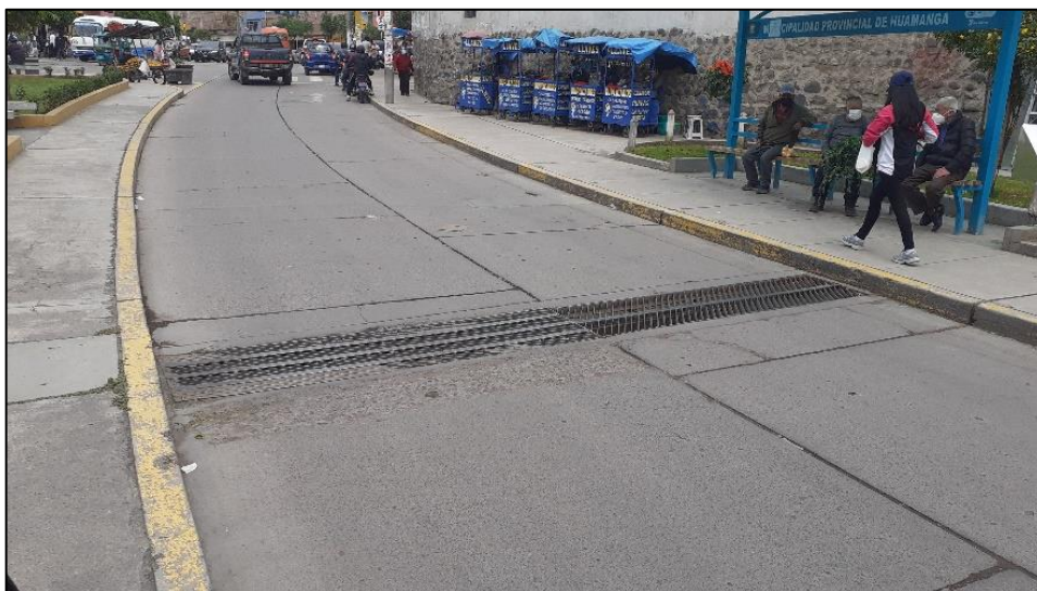
Figura 3.12 Sumidero en el colector San Lorenzo (antes de llegar al óvalo Puente Nuevo)
