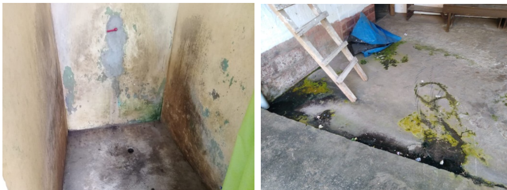
GRAFICO 93: Hongos en las duchas de los baños de las habitaciones.
