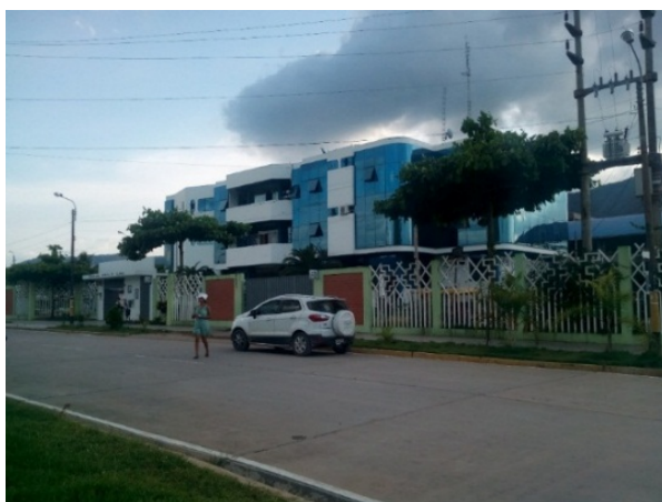
GRAFICO 110: Muro cortina en la Municipalidad de Mazamari. Ausencia de elementos de protección del asoleamiento en las fachadas.
