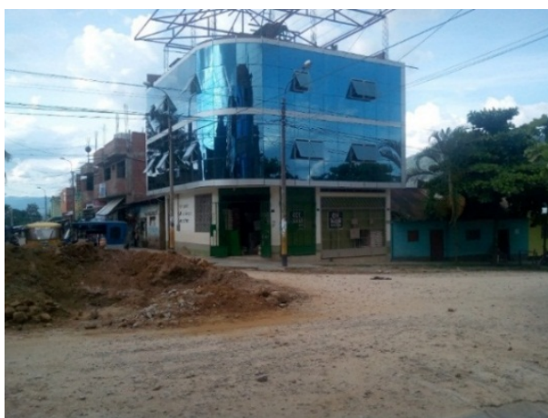
GRAFICO 109: Edificio con techo plano. Ausencia de mecanismos de evacuación de agua de lluvia.
