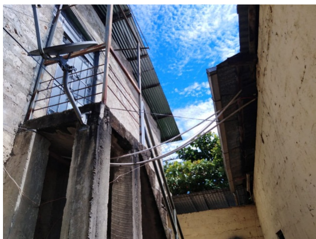
GRAFICO 84: Cables expuestos al exterior, en el ingreso principal.
