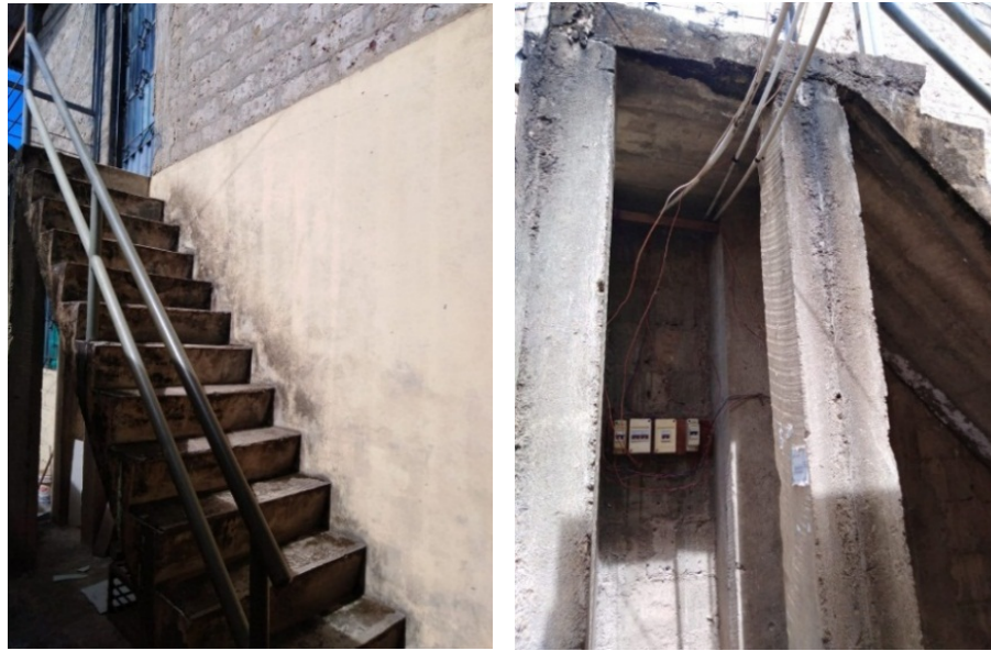
GRAFICO 85: Ausencia de señalización y extintores en el ingreso principal. A la derecha, tablero de distribución sin protección, los cables sin protección llegan a él. Fuente: Propia
