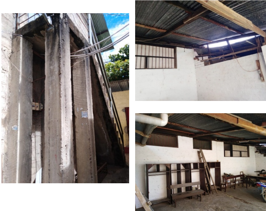
GRAFICO 86: Cables expuestos a la intemperie, sin protección. Fuente: Propia
