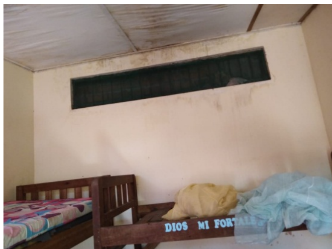
GRAFICO 95: Humedad en el cielo raso, debido a las filtraciones de agua de lluvia por el techo de calamina, afectando la salud de los estudiantes.
