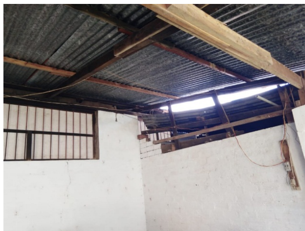
GRAFICO 92: Uso de materiales poco aislantes, que conducen el calor rápidamente hacia los interiores, generando incomodidad.
