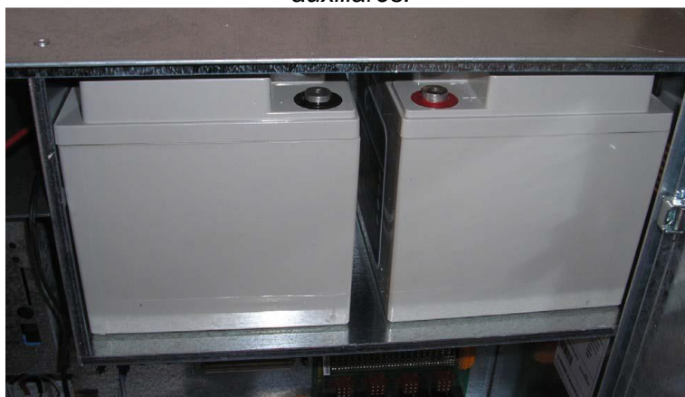
Ilustración 2-20: Banco de baterías de 12V para energización de UP Interior y servicios auxiliares.
