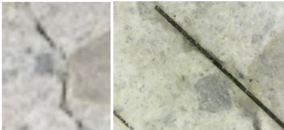
Evaluación de la fisura 4(P) - a/c = 0.50
