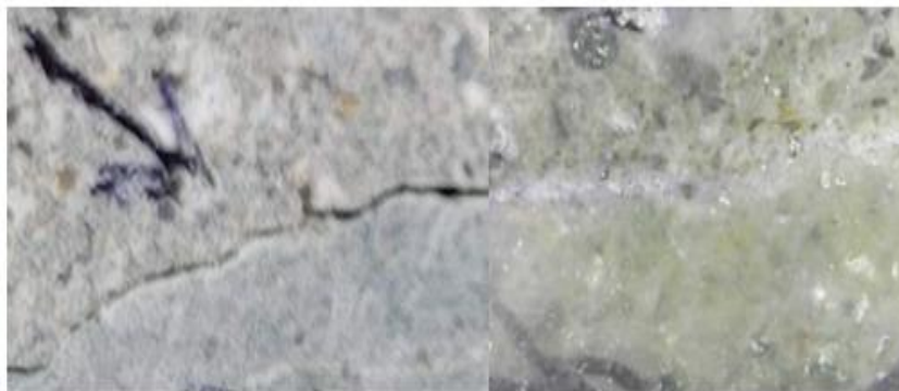
Figura 2. Fisura reparada - Concreto adicionado con bacterias a/c 0.50. Fuente propia.
