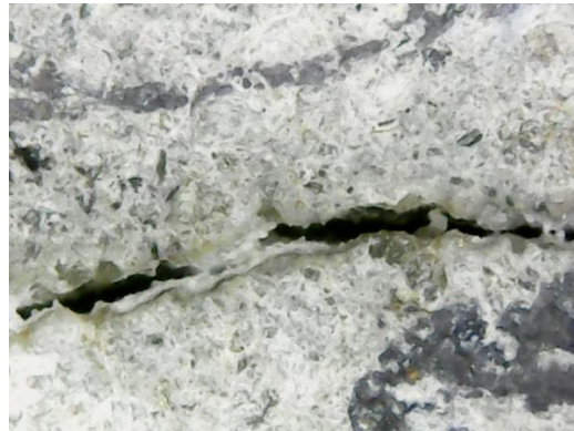
Evaluación de la fisura 3(B) – a/c = 0.45
