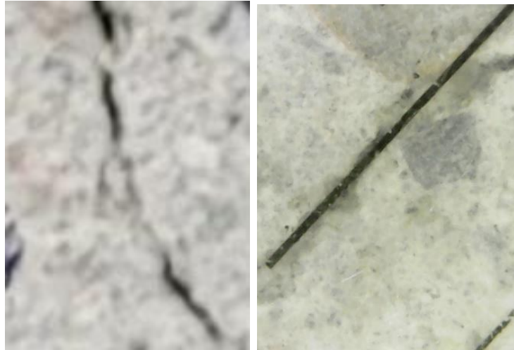
Evaluación de la fisura 4(P) - a/c = 0.45
