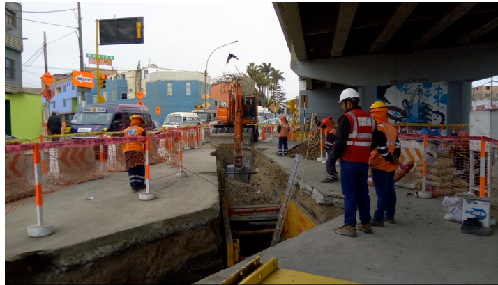
Figura N° 5.14: Redes de agua potable instaladas en fase de Acuerdo de Encargo E2 (no operativas)
