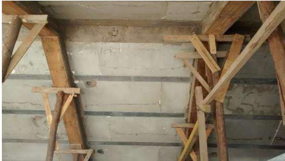
Imagen 4: Vista inferior de losa aligerada, como se aprecia no se utiliza encofrado para el soporte de viguetas.
