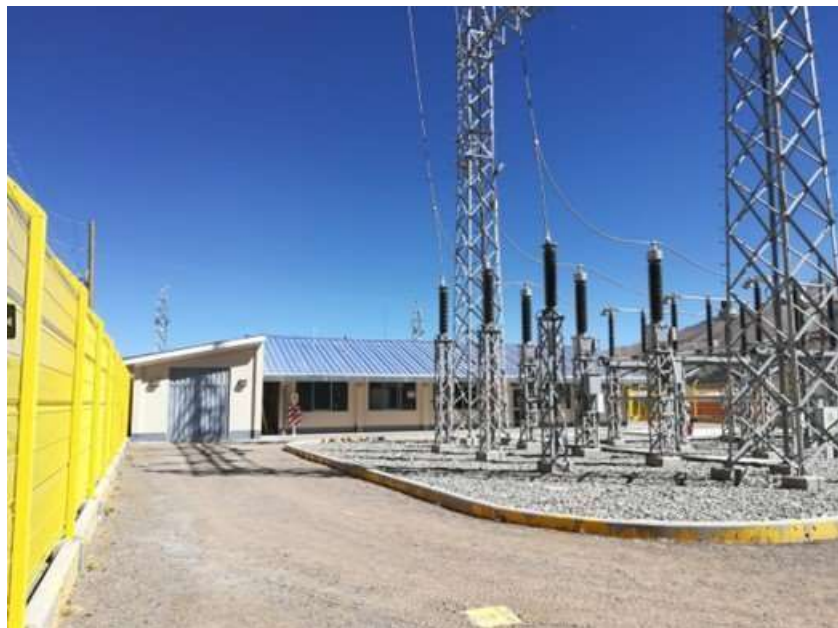
Imagen 20: Patio de llaves en funcionamiento
