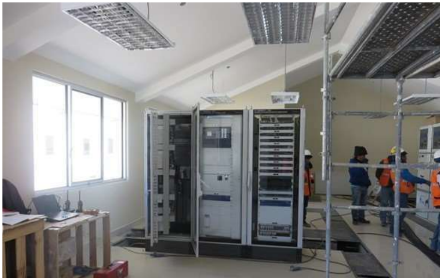
Imagen 16: Instalación de celdas de comunicación en sala de control, conectadas mediante el cableado dentro de canaletas debajo del piso.
