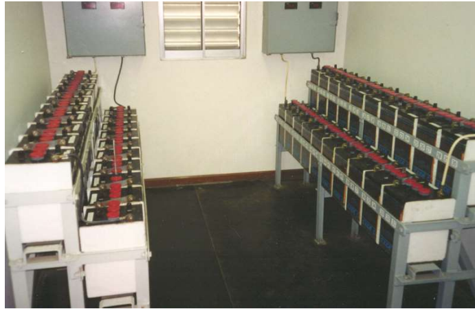
Figura 19: Sala de baterías.
