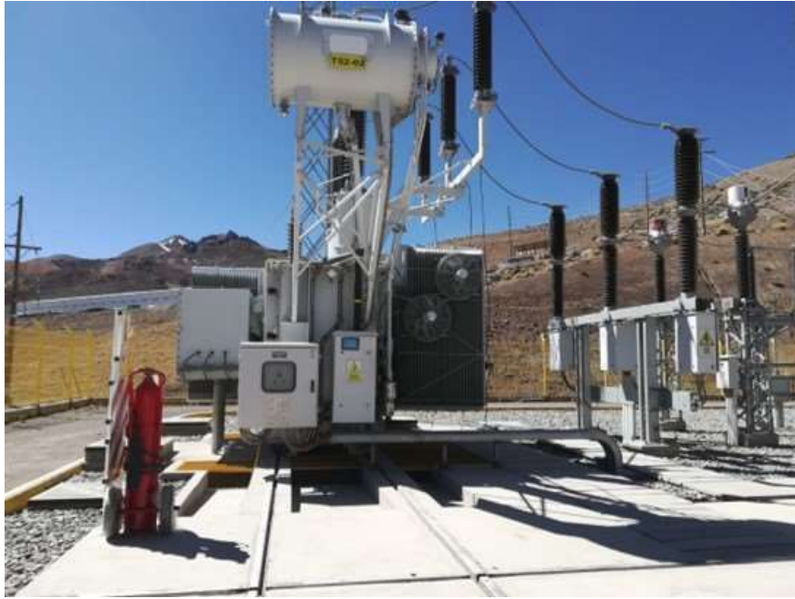
Imagen 19: Disposición final de transformador de potencia
