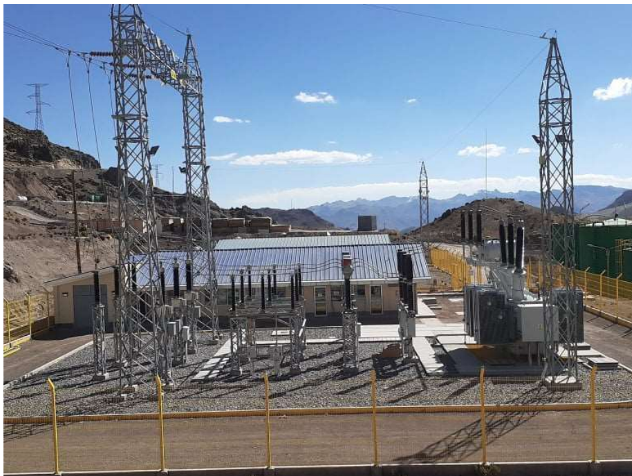
Imagen 18: Patio de llaves en funcionamiento
