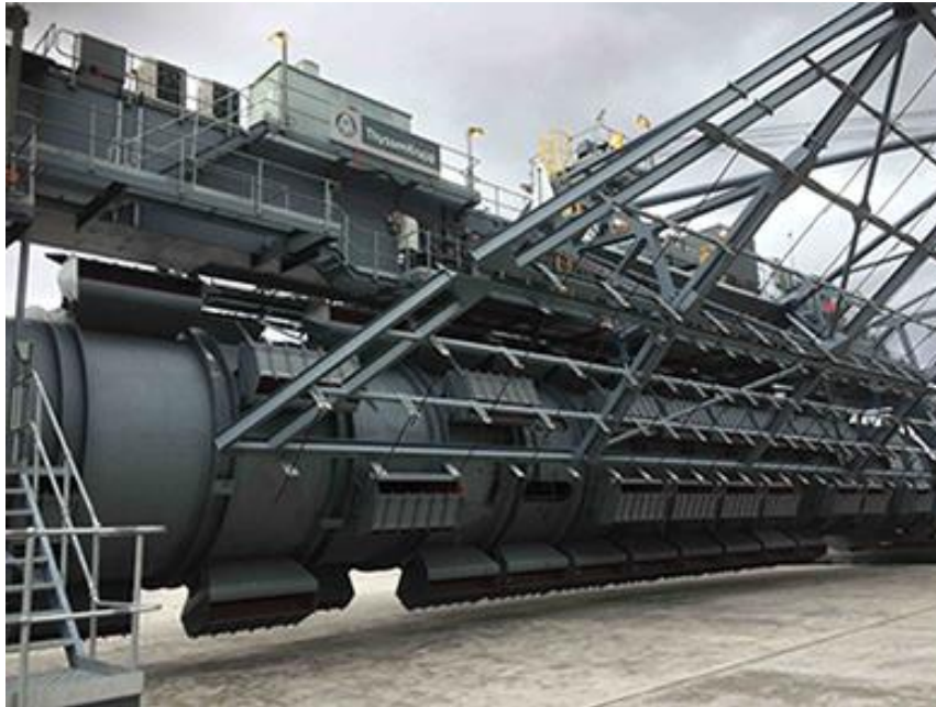
Fuente: Pineda R, 2022, Drum Reclaimer, Stock de Paquete 6 Zona Nueva Shougang Hierro Perú.
