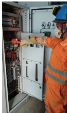
Revelado de tensión en el tablero SS.AA de AC
