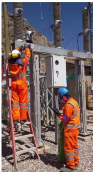
Llenado de gas SF 6
