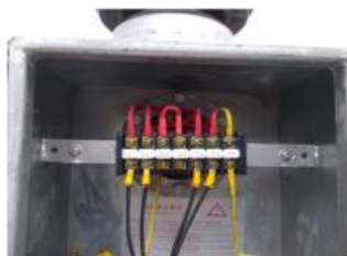
IDENTIFICACIÓN DE TERMINALES SECUNDARIOS DEL TC
