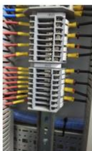
BORNERAS SECCIONABLES DEL TABLERO DE PROTECCIONES
