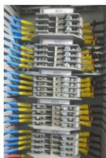
BORNERS SECCIONABLES DEL TABLERO DE PROTECCIONES
