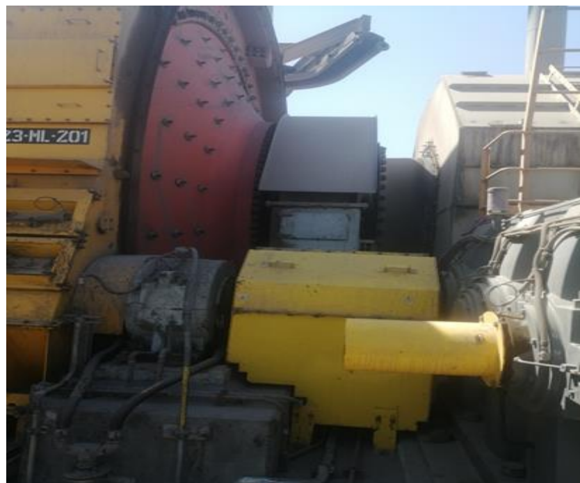
Figura N°18: Sistema de descarga del molino de bolas outotec 24'x36'.
