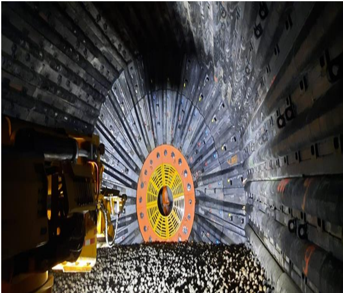
Figura N°45: Revestimiento interno del molino de bolas outotec 24'x36'.
