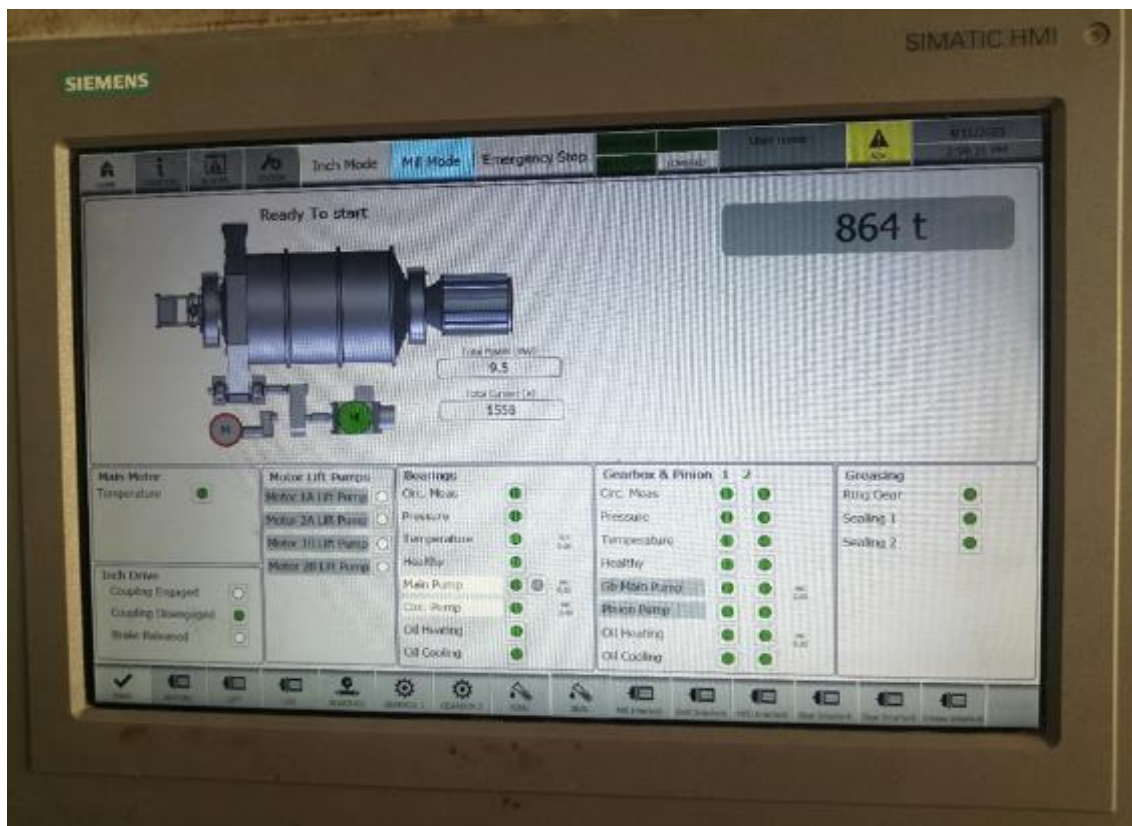
Figura N°11: Verificación de componentes del molino de bolas outotec 24'x36' en el panel central modo mill mode.
