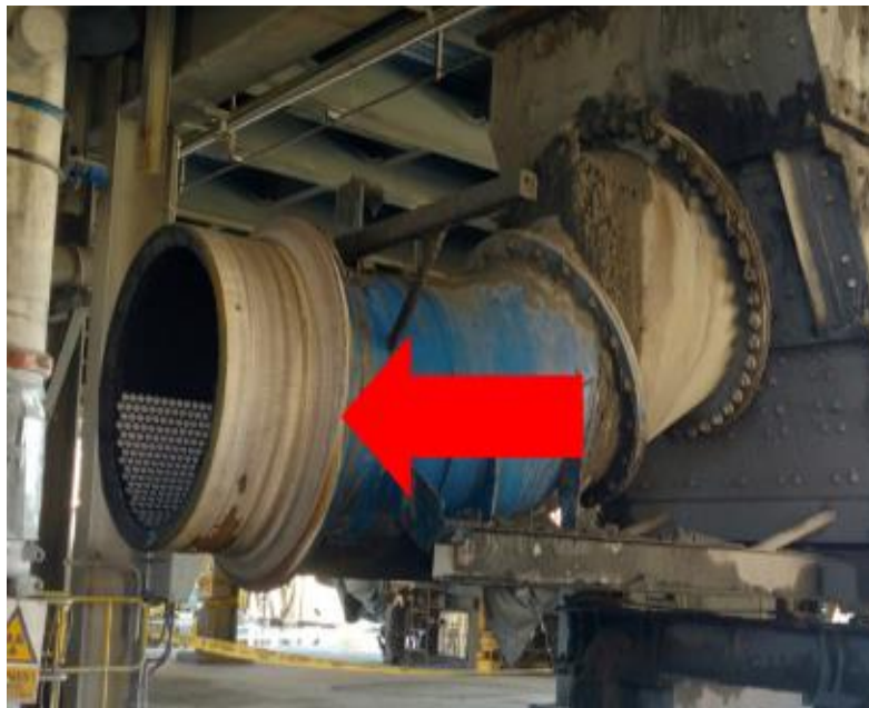
Figura N°29: Zona de descarga spout feeder del molino de bolas outotec 24'x36'.
