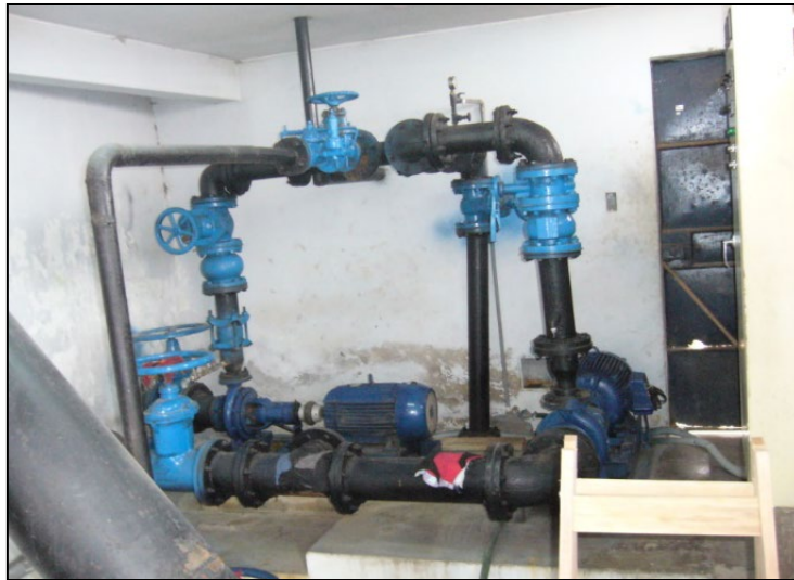
Figura 46. Árbol Hidráulico del RE-89A
