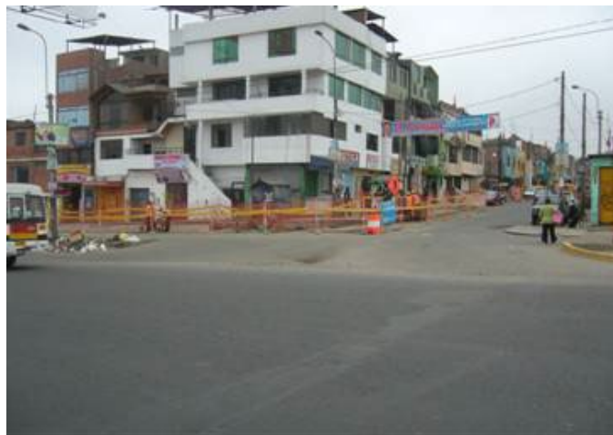
Figura 29. Vista del pozo P-204
