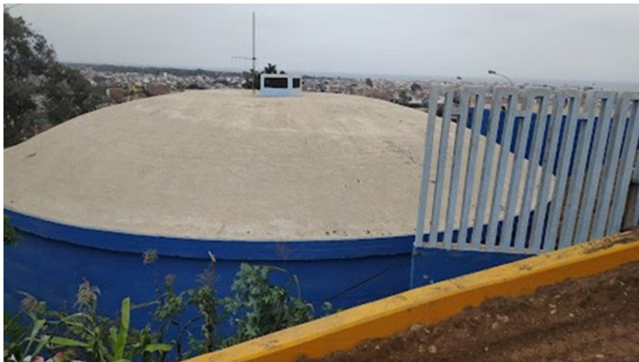
Figura 32. Vista de los reservorios RE-278 y RE-279, alimentados por el pozo P-232 inoperativo
