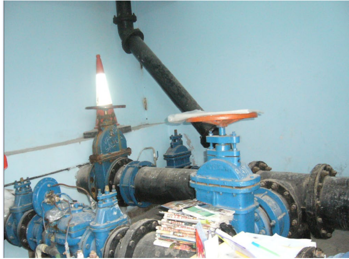
Figura 44. Vista de la distribución hidráulica del RE-88A
