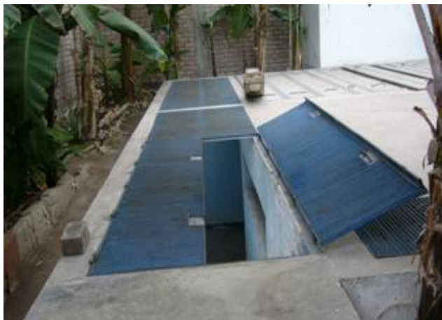
Figura 40. Vista del pozo P-718
