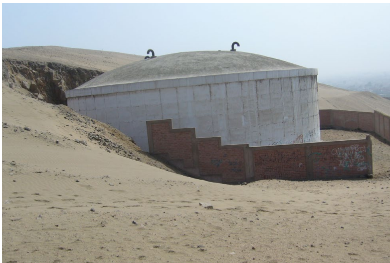
Figura 64. Vista de Reservoirio RA-123B
