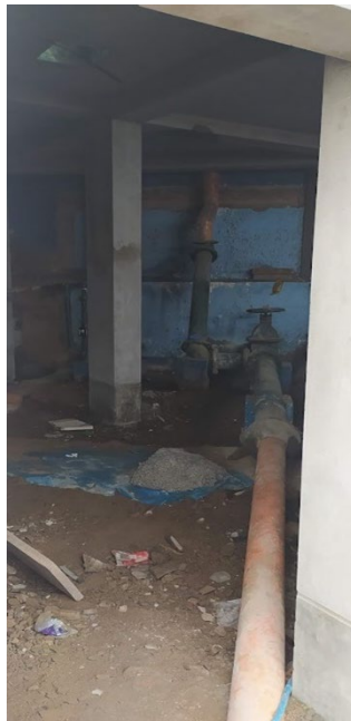
Figura 61. Vista de cuarto de bombas del Reservorio RA-97C Fuente: Propia
