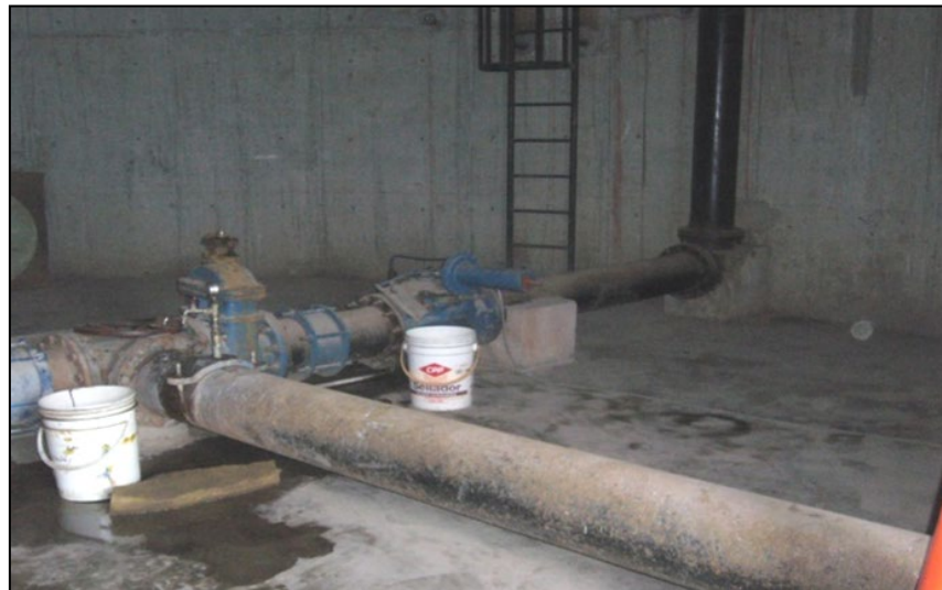
Figura 42. Tubería de Ingreso al RE-87A Fuente: Propia
