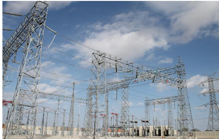
Figura N° 4 Subestación de intemperie
