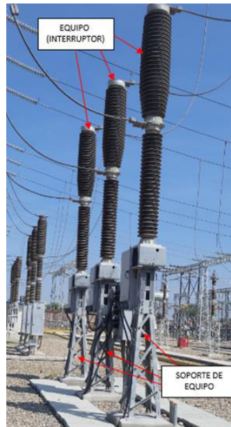
Figura N° 12 Estructuras de soportes de equipos
