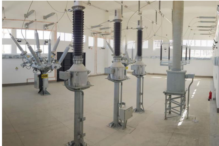
Figura N° 5 Subestación de interior
