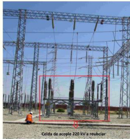
Figura N° 34 Celda de acople 220 kV a reubicar – SE. Piura Oeste.
