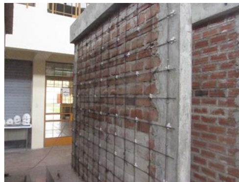
Figura N° 180. Fijación de malla de acero al muro de albañilería con Alambre N°8 y crucetas de 10mm.
