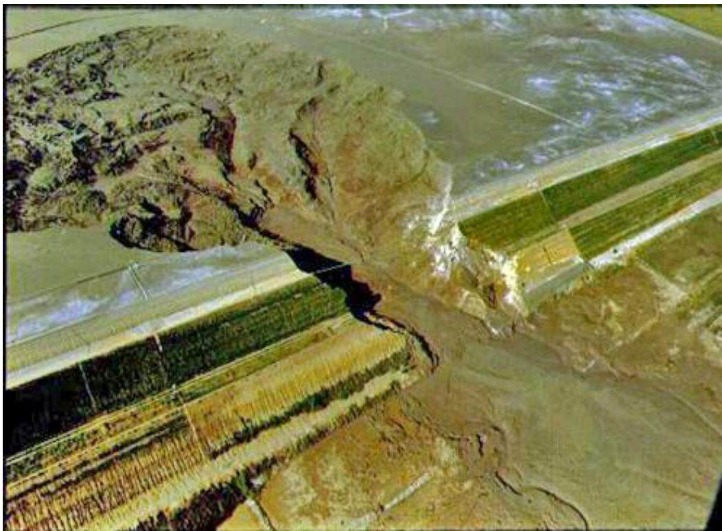
Figura 2.33 Vista de la falla de la presa Merriespruit-Sudáfrica (1994). Fuente: Adaptado de Minerals Council-South Africa (s.f.). Consultado el 07 de junio del 2021. https://cutt.ly/tnmVeTi
