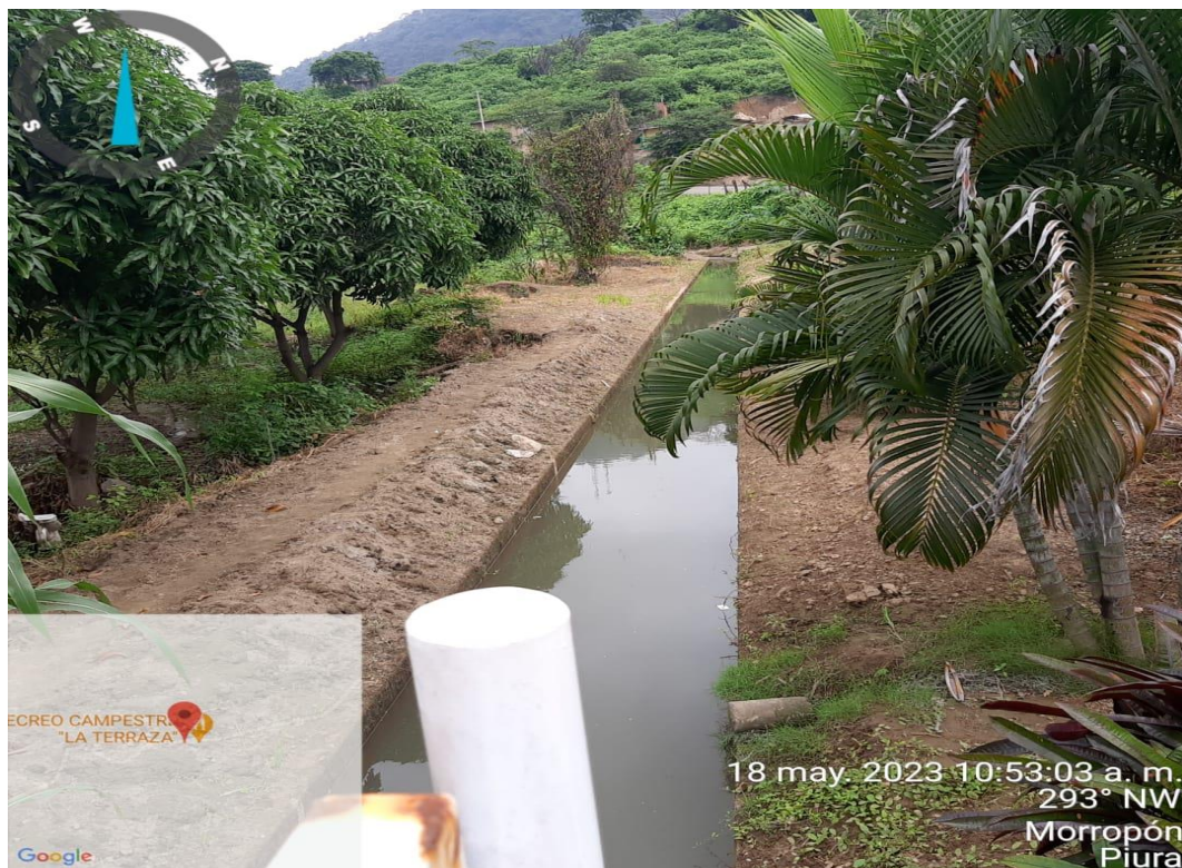
Figura 29. Muestra canal embalsado entre progresivas 4+450 a 4+500, por efecto de ingreso de sedimentos que entrega alcantarilla ubicada en km 4+530, directo al canal.
