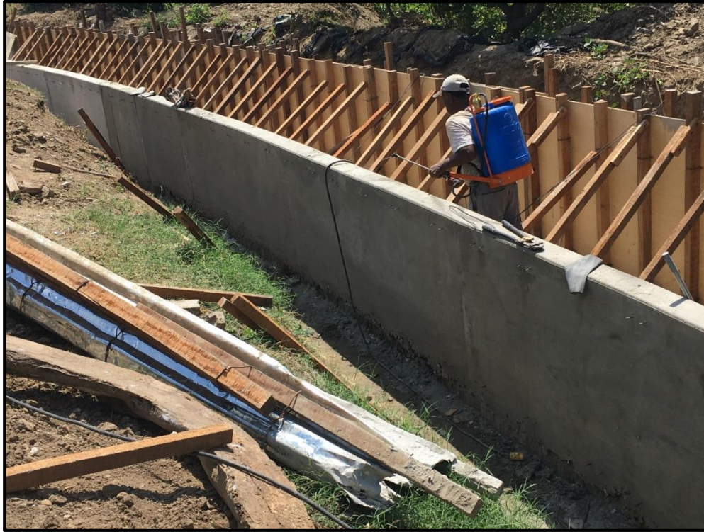
Figura 13. Véase muro izquierdo de canal desencofrado y muro derecho con encofrado colocado.
