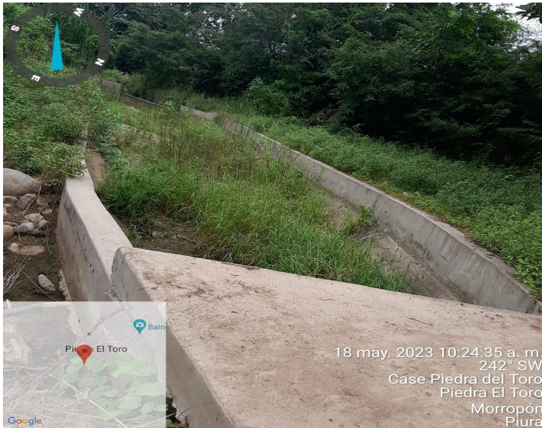
Figura 26. Muestra compuerta izquierda que permite el ingreso del agua hacia el desarenador, sin funcionamiento, ubicado en progresiva 0+108.
