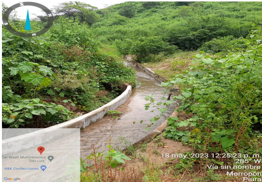
Figura 34. Muestra canal funcionando, con falta de limpieza de bermas y camino de vigilancia, situación que consideramos debe corregirse en el más breve plazo, progresiva 8+060.
