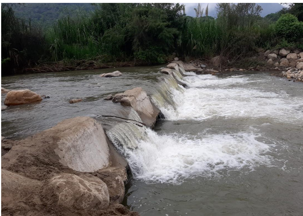
Figura 23. Muestra funcionamiento de bocatoma la gallega, el 18-05-2023, con la intervención del proyecto, no se ha rehabilitado ni colchón de amortiguamiento, ni base del barraje, (el proyecto no lo ha considerado).
