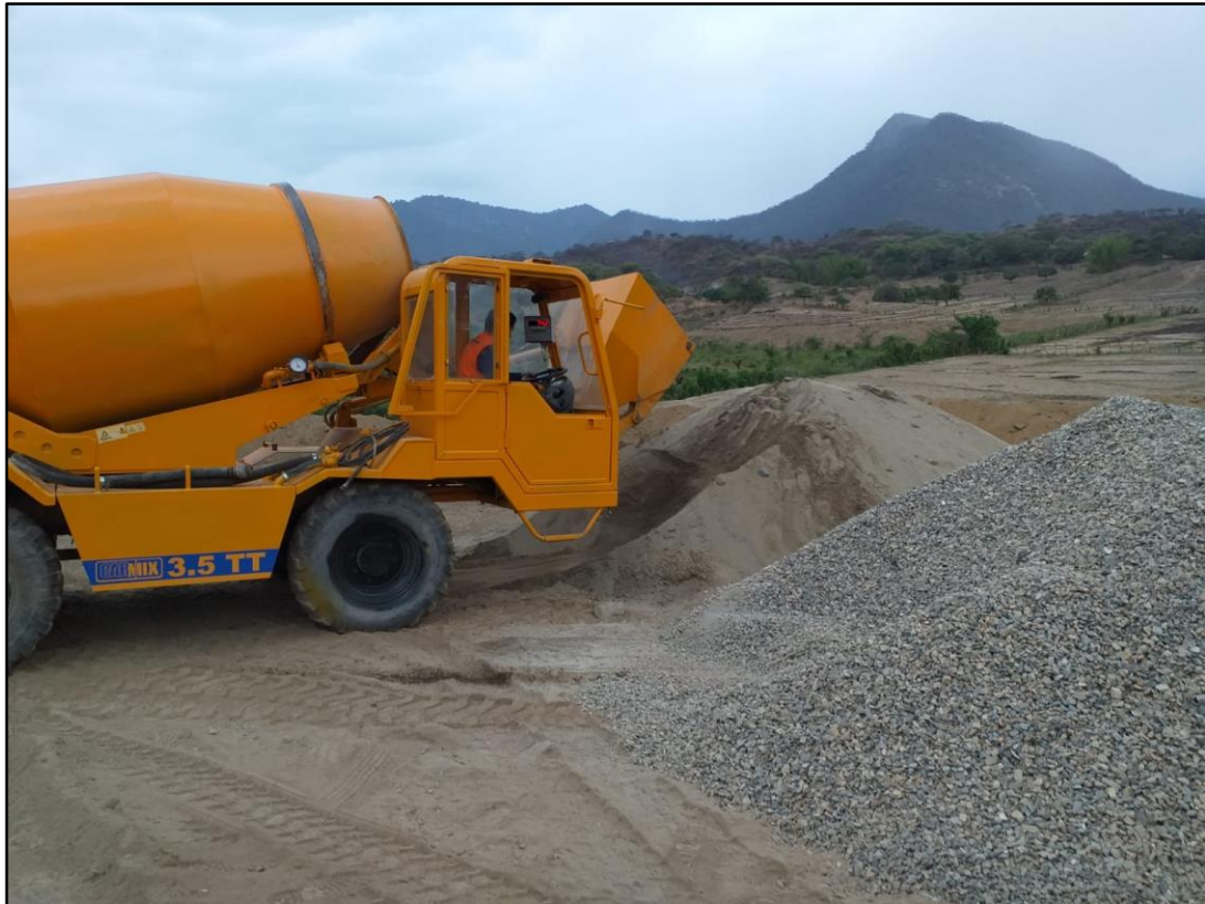
PREPARACIÓN DEL CONCRETO CON EL CARMIX SE OBSERVA LOS AGREGADOS EN LAS DIMENSIONES Y CANTERAS QUE INDICA EL DISEÑO DE MEZCLAS.
