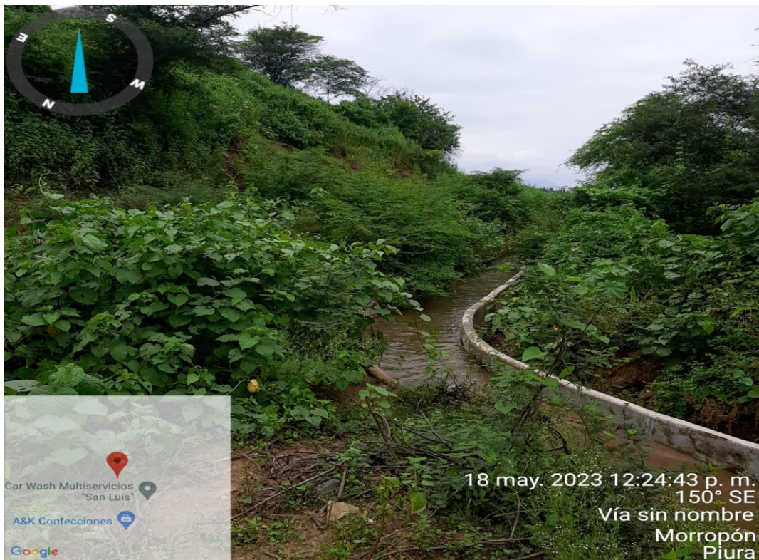
Figura 35. Muestra otro tramo de canal que necesita limpieza de camino de vigilancia y borde izquierdo, urgente.
