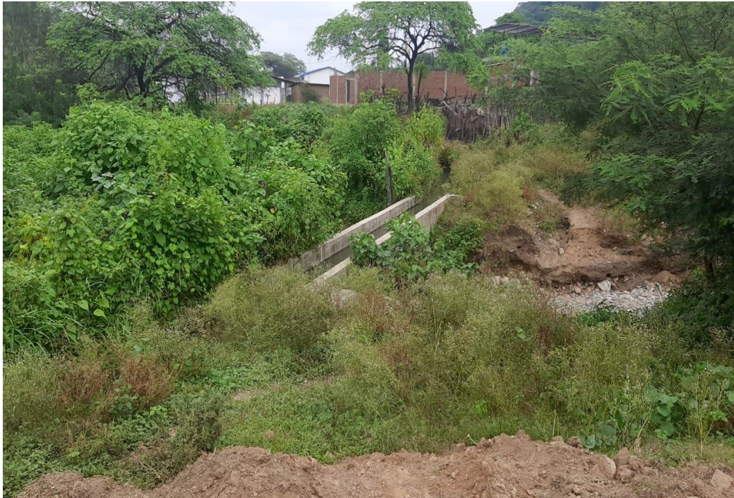
Figura 30. Muestra canoa en perfecto estado de funcionamiento, ubicado en progresiva 5+140, sobre zánora, obsérvese falta de limpieza de maleza en bermas de canal (junto a estadio San Luis).
