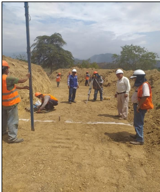
TRABAJOS DE TRAZO, NIVELACIÓN Y REPLANTEO – EMPLANTILLADO SECCIÓN DEL CANAL, CON LA PRESENCIA DEL SUPERIOR Y RESIDENTE DE OBRA.
