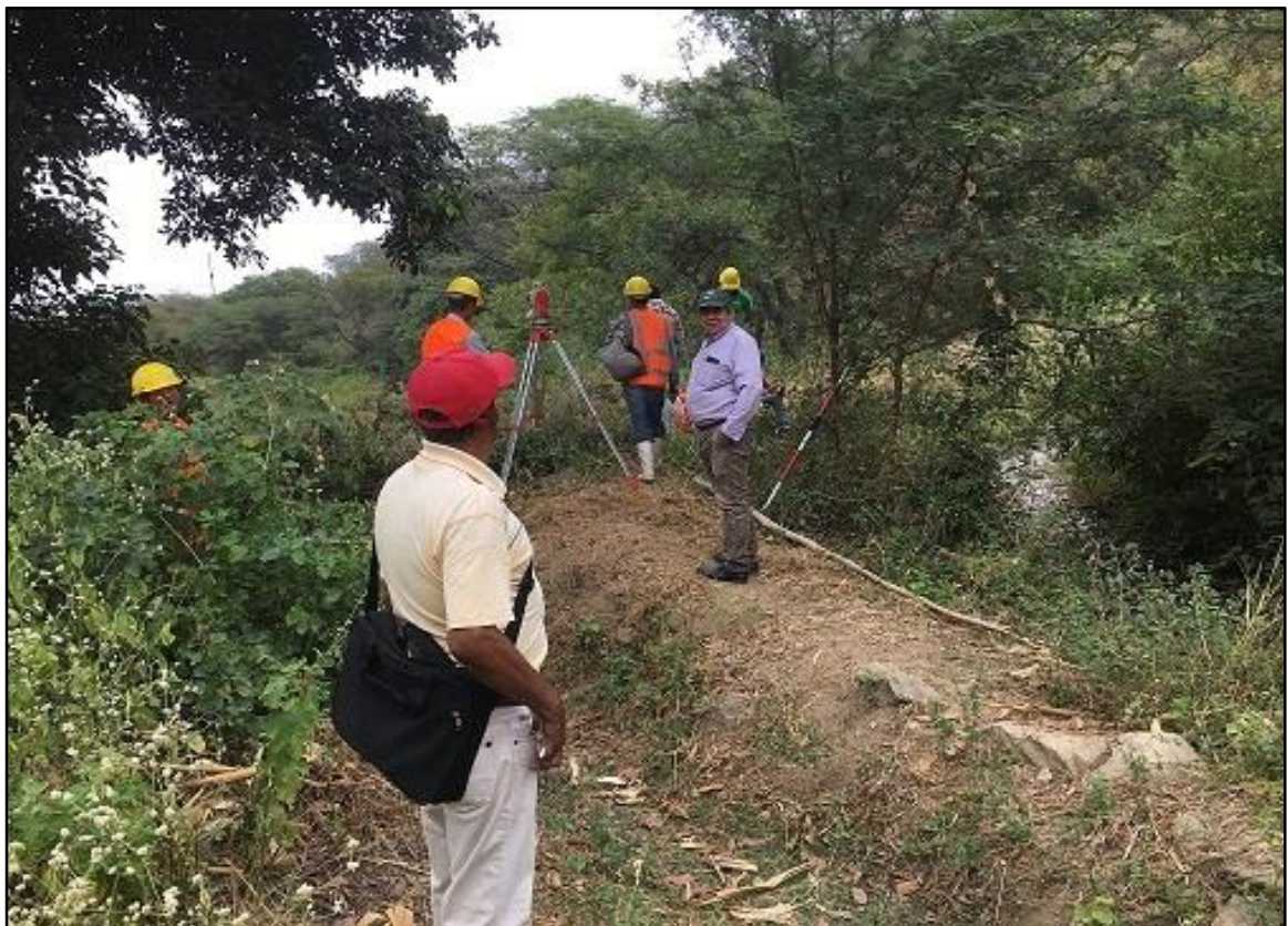
TRAMOS DEL CANAL PIEDRA EL TORO EN TERRENO NATURAL QUE HA SIDO RETIRADO LA VEGETACIÓN EN LA ETAPA DEL EXPEDIENTE TÉCNICO.
