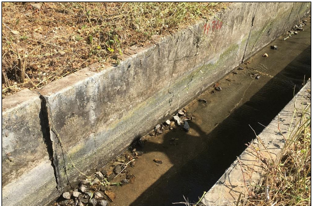
PAÑO DE MURO COLAPSADO REQUIERE DEMOLICIÓN Y SER REEMPLAZADO CON UN PAÑO DE CONCRETO NUEVO.
