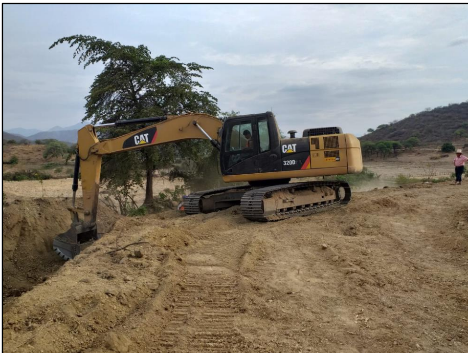
Figura 9. Excavadora realizando trabajos de movimiento de tierras en caja de canal y camino de acceso o de vigilancia
