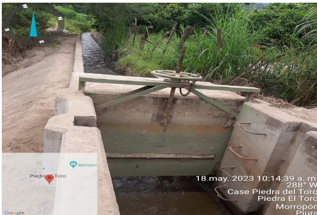
Figura 25. Muestra la compuerta de ingreso al canal piedra el toro, observando su correcto funcionamiento e ingreso del caudal de agua requerido.
