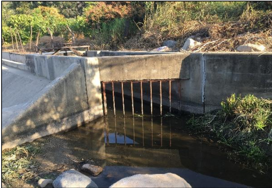
ESTRUCTURA DE BOCATOMA EXISTENTE DONDE SE OBSERVA EL INICIO DE JUNTAS DETERIORADAS
