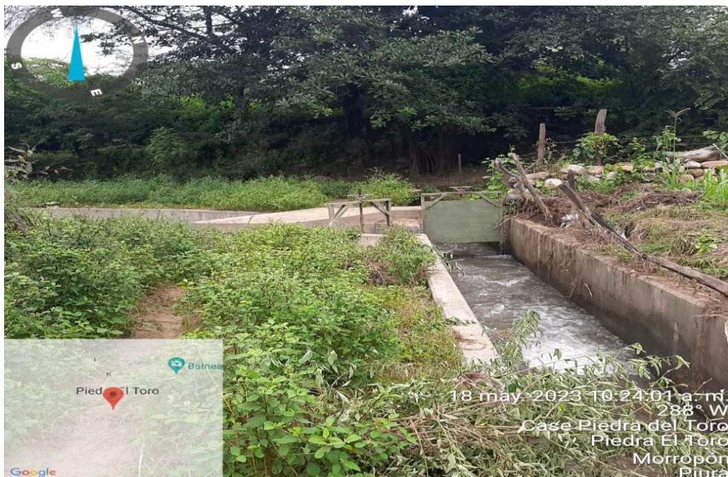
Figura 27. Muestra estructura de desarenador lleno de sedimentos, maleza y sin que se haya puesto en funcionamiento a la fecha.
