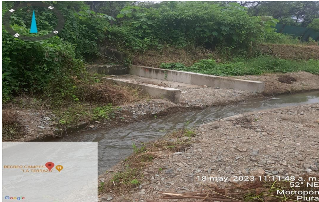
Figura 28. Muestra ingreso del agua de lluvia por vertedero, proveniente de alcantarilla con arrastre de arena y grava, material que se deposita en canal obstruyendo su normal funcionamiento, km 4+530.
