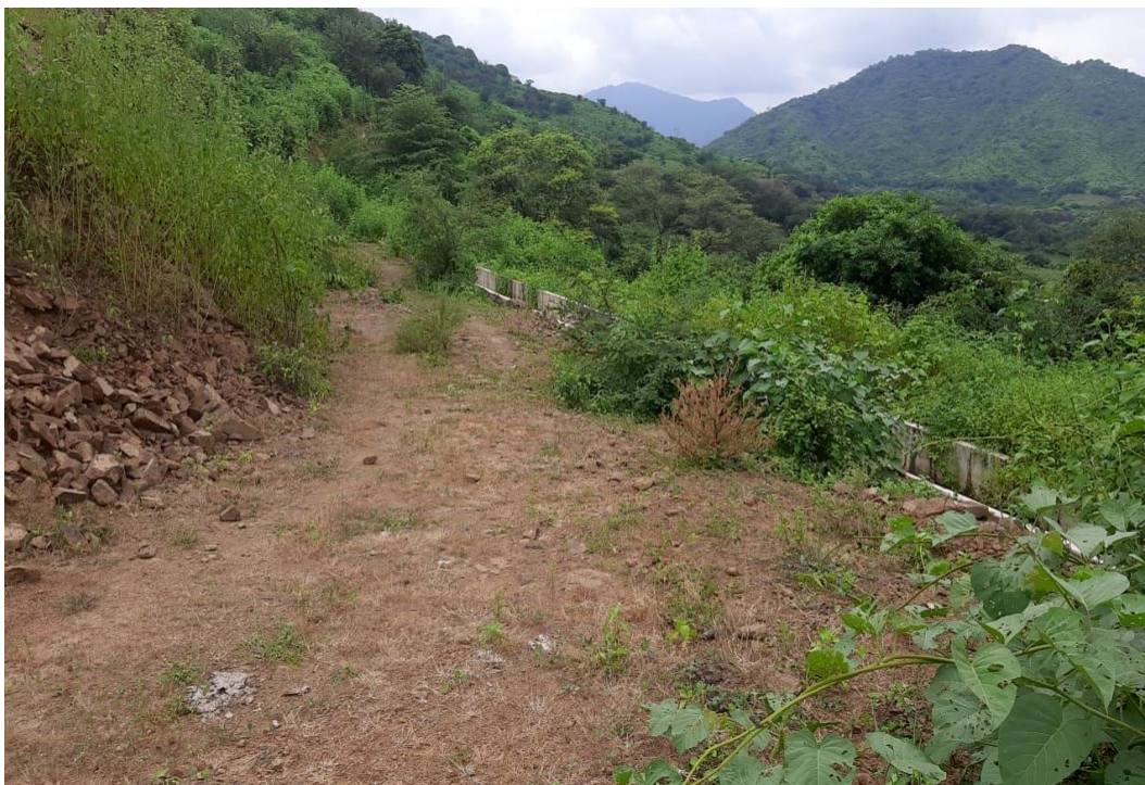
Figura 39. Muestra camino de vigilancia paralelo al canal, limpio de arbustos, por ser plataforma rocosa, construido por cuenta del contratista, para facilitar ejecución y cumplimiento de plazo contractual, km 7+950 hacia atrás.
