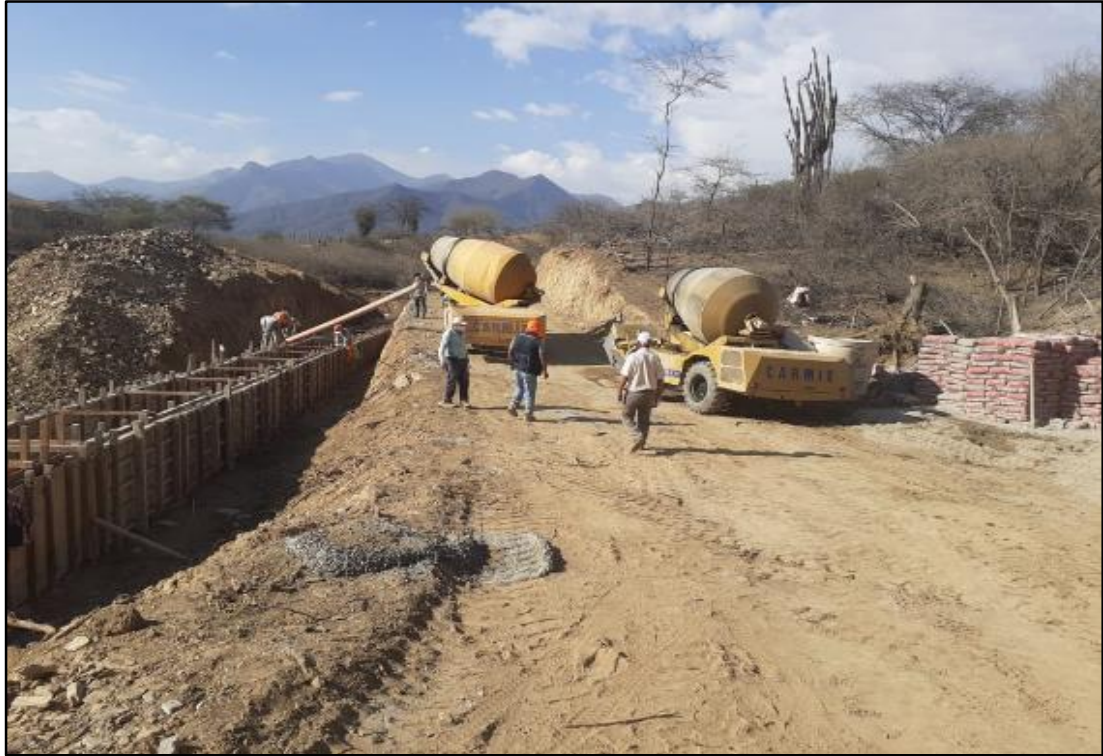
VACIADO DE CONCRETO EN LOS MUROS DEL CANAL CON 02 CARMIX DE 3.5 M3
