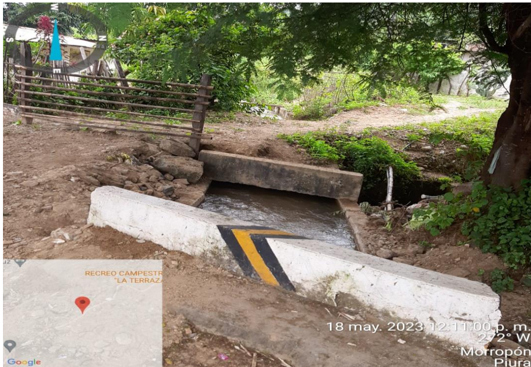
Figura 31. Muestra funcionamiento del canal en progresiva 5+600, saliendo de alcantarilla que cruza la pista, se aprecia poco borde libre, por material colmatado en fondo de canal.
