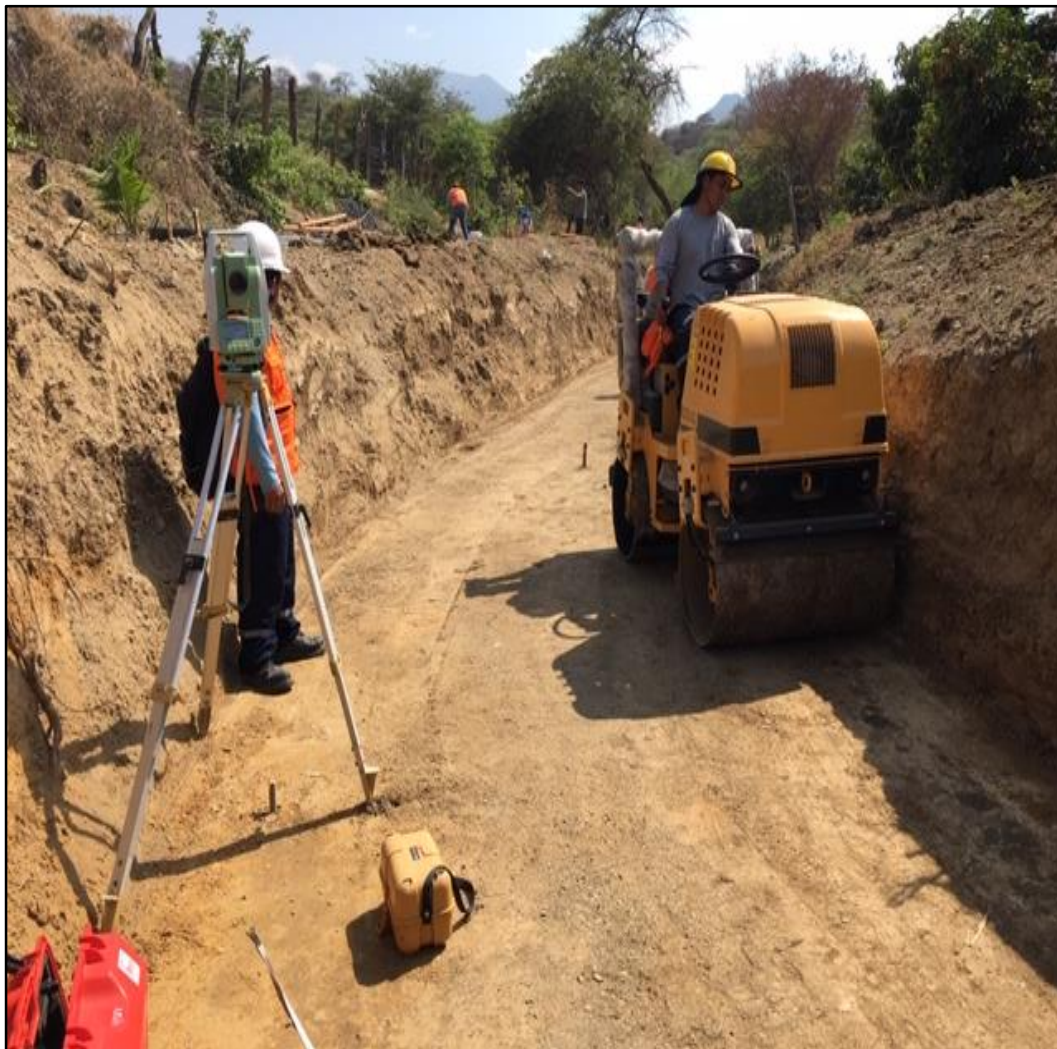
Figura 10. Trabajos de relleno y compactación con rodillo liso autopropulsado de la sub rasante del canal
