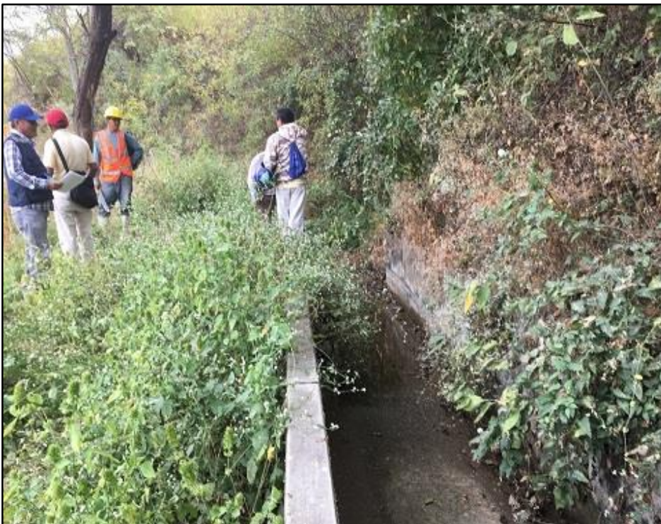
TRAMO DE CANAL DE CONCRETO EXISTENTE CON PRESENCIA DE VEGETACIÓN QUE OBSTRUYE EL CAMINO DE SERVICIO Y EN LA MARGEN DERECHA NO EXISTE UNA BERMA NATURAL..
