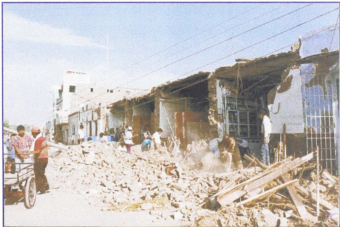
Foto N° 2: Vista panoramica del estado en que quedo la calle lima de Nasca, se utilizo este indicador para aproximar el estado de nuestras lineas de agua y desague.
