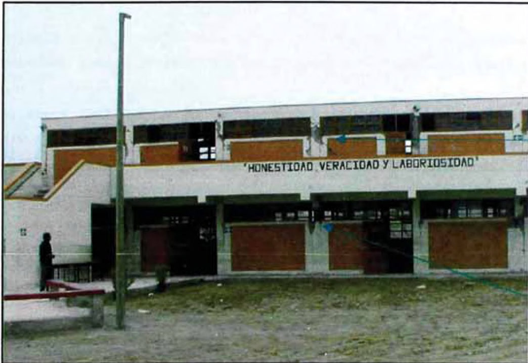
Figura No 4.3 Problema de columna corta, junta deficiente entre columna y alfeizar y ventana.
