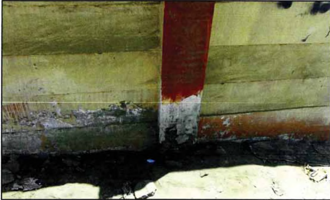
Figura No 4.14 Cerco de madera con elementos rígidos de concreto armado en muy mal estado, en eventual sismo los cercos pueden sufrir el colapso tanto los cercos de madera como los de albañilería dejando sin ningún resguardo a la institución educativa.
