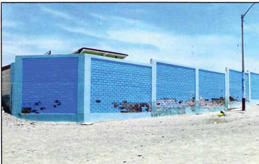
Figura No 4.13 Cerco en muy mal estado de conservación, muros con presencia de salitres, que afectan la resistencia de la albañilería y la corrosión de la armadura de los elementos confinantes.
