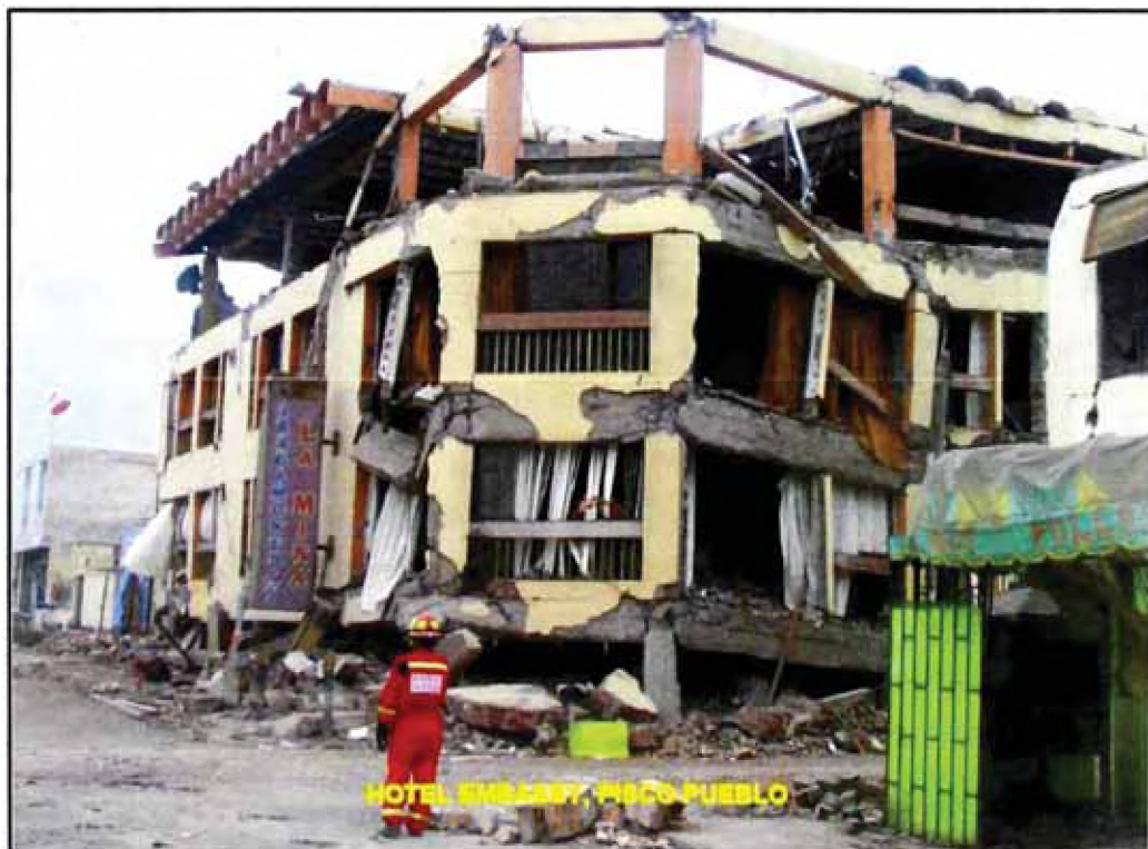
Figura No 4.4 Falla de edificación por deficiente diseño, ausencia de asesoramiento especializado por un ingeniero y posiblemente pobre calidad de los materiales.
