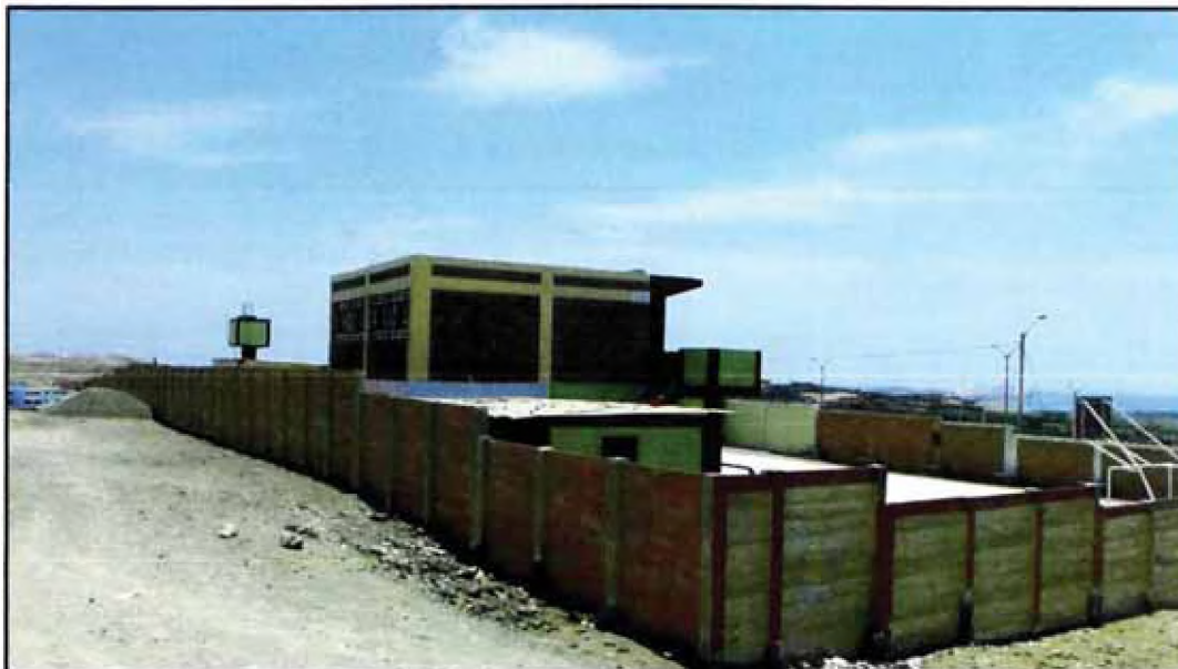
Figura No 4.12 Sistema estructural sísmica a base de pórticos de concreto armado, se notó la inexistencia de junta sísmica entre las columnas de concreto armado y el alfeizar. La inexistencia de la junta puede provocar el fenómeno de columna corta en un eventual sismo, lo cual podría provocar daño estructural de consideración a la edificación
