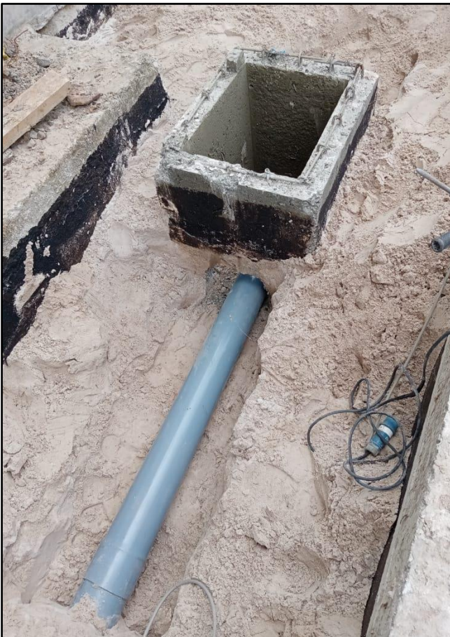
IMAGEN N°14: Antes de enterrar las tuberías de desagüe con arena, los elementos hidráulicos de concreto deben ser protegidos con alquitrán en su exterior, así mismo se debe realizar la prueba de estanqueidad a los tramos de tubería instalados.
