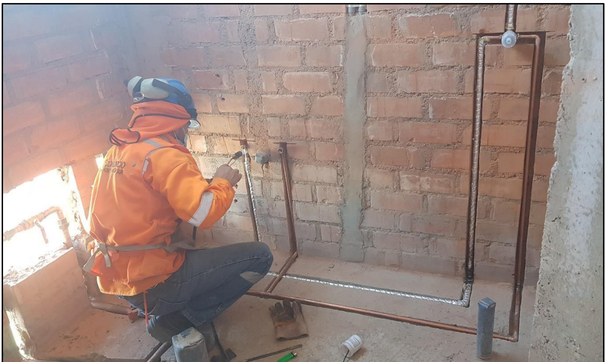
IMAGEN N°6: Se observa que las tuberías de agua caliente han sido recubiertas con aislamiento de lana de vidrio, de manera que estas eviten la pérdida de calor del sistema en todo el trayecto que va desde el cuarto de bombas hasta los puntos que lo requieran.
