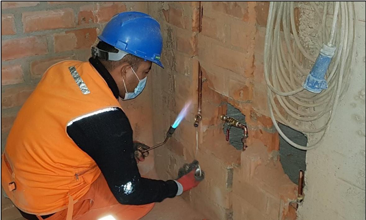
IMAGEN N°5: Antes de realizar la instalación de los elementos de cobre en los espacios proyectados se verificó la existencia de interferencias, de presentarse estas se procedió a presentar una propuesta de modificación de manera que no existe interferencias.
