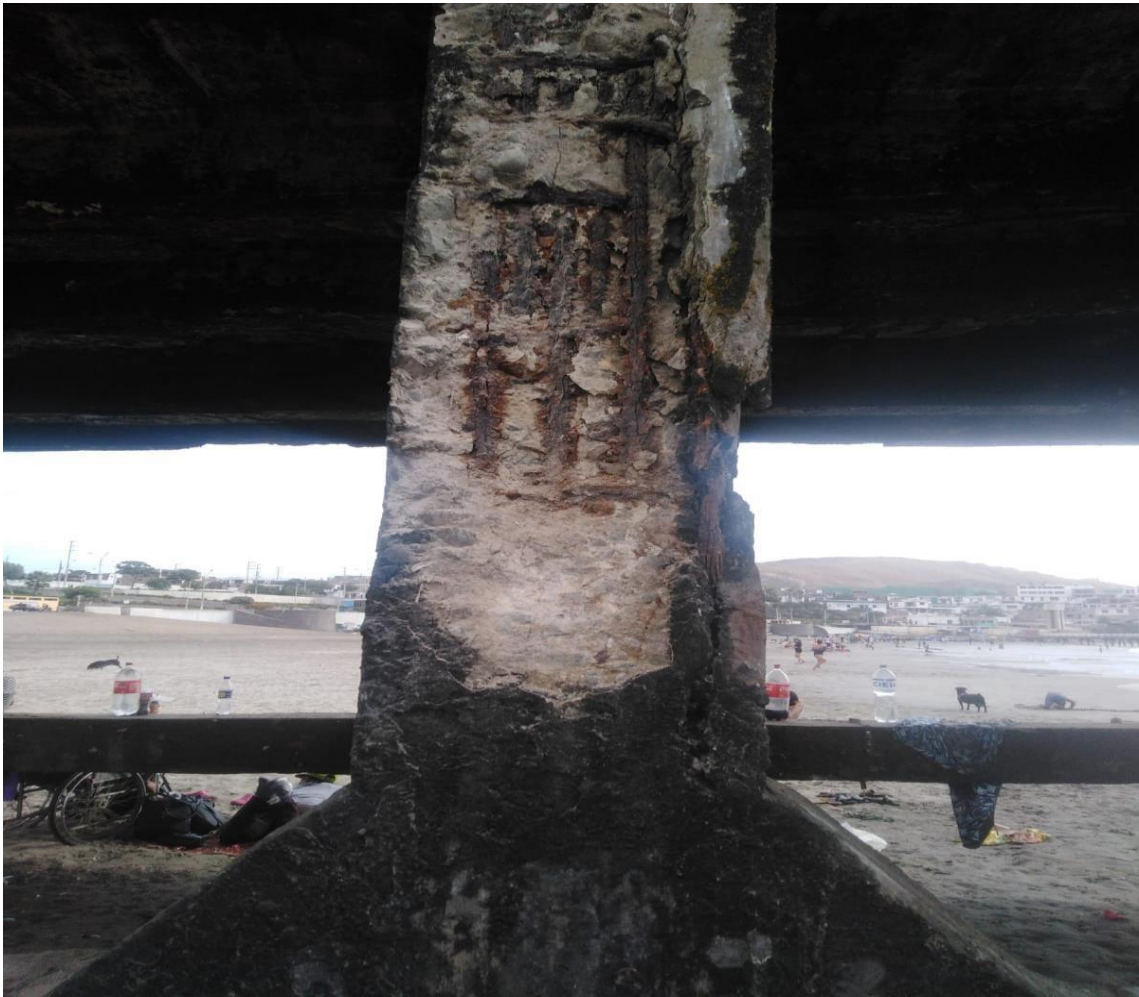
Imagen 2. Estructura de Concreto Armado (afectada por corrosión)
