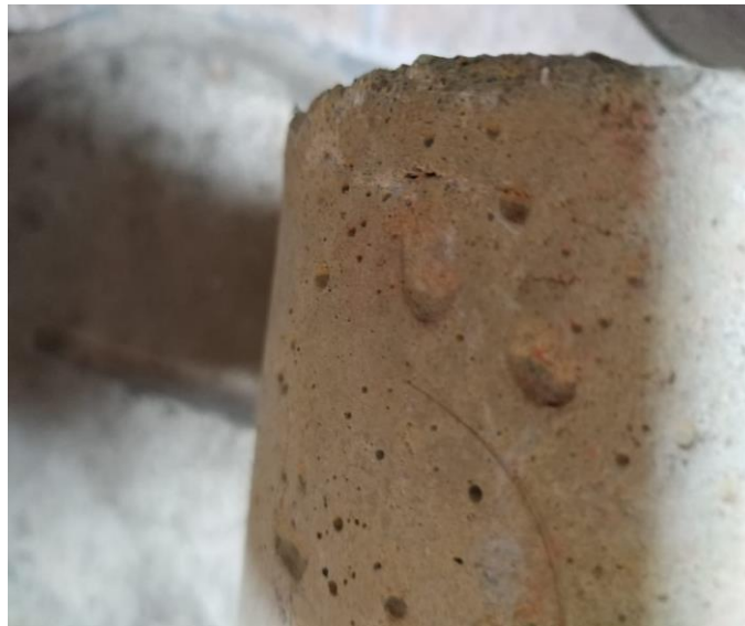
Imagen 12. Muestras de concreto armado con manchas de color rojizo
