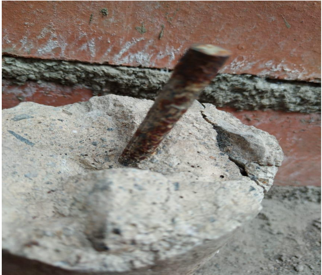
Imagen 13. Fierro \varnothing 3/8 " en estado de oxidación
