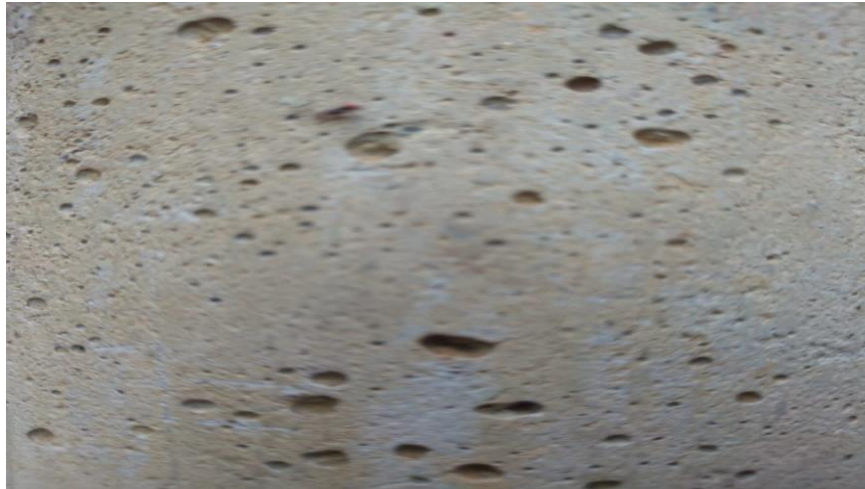
Imagen 11. Picaduras en el concreto armado y manchas
