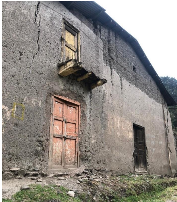
Figura N° 7.16. Vivienda con características físicas inadecuadas en el distrito de Quivilla
