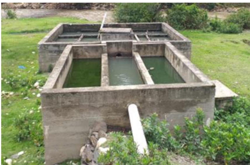
Figura N° 6.29. PTAR inoperativa del distrito de Quivilla
