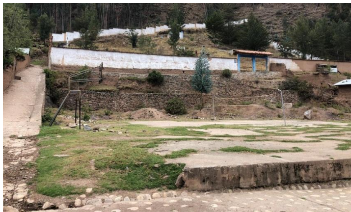
Figura N° 6.35. Losa deportiva en malas condiciones en el distrito de Quivilla
