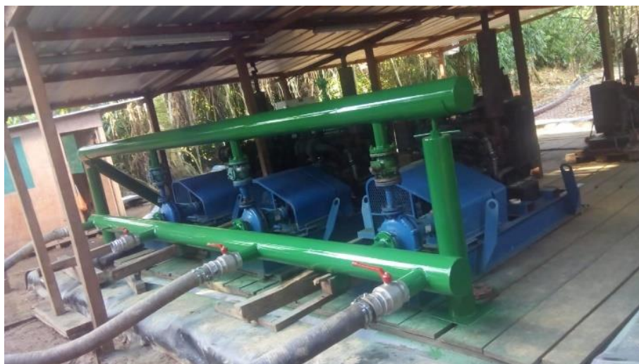
Anexo A.1.83. Bombas y Manifold de Impulsión
