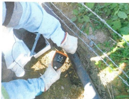
Foto 4: Medición de espesor de tubería HDPE 2" con equipo UT, resultado prom.: 5.0mm. Lado HP5
