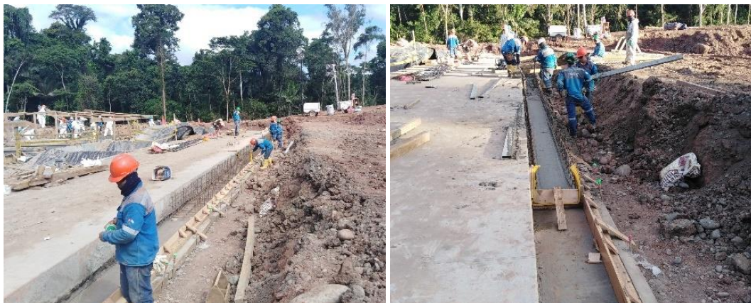
Anexo A.1.44. Canal Interno para Zona de Perforación – Instalación de Water Stop
