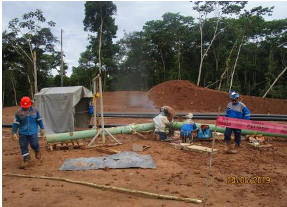
Anexo A.1.57. Trabajos de Soldadura y Revestimiento de Juntos de Tuberías de Acero
