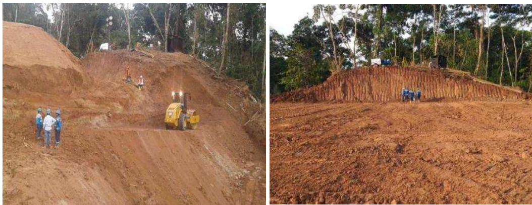
Anexo A.1.20. Inicio de Trabajos de Corte y Relleno Masivo – Sector A-9
