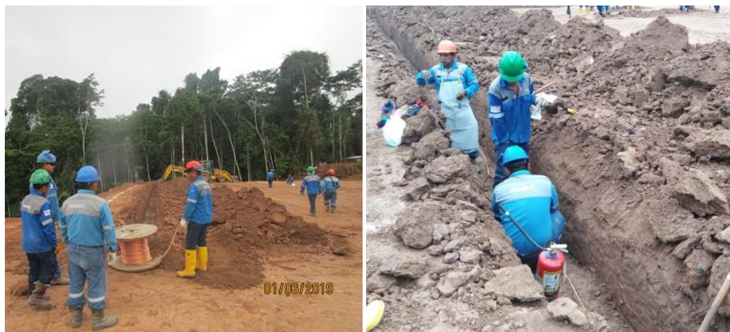
Anexo A.1.71. Tendido de Cable de Puesta a Tierra y Soldadura Exotérmica
