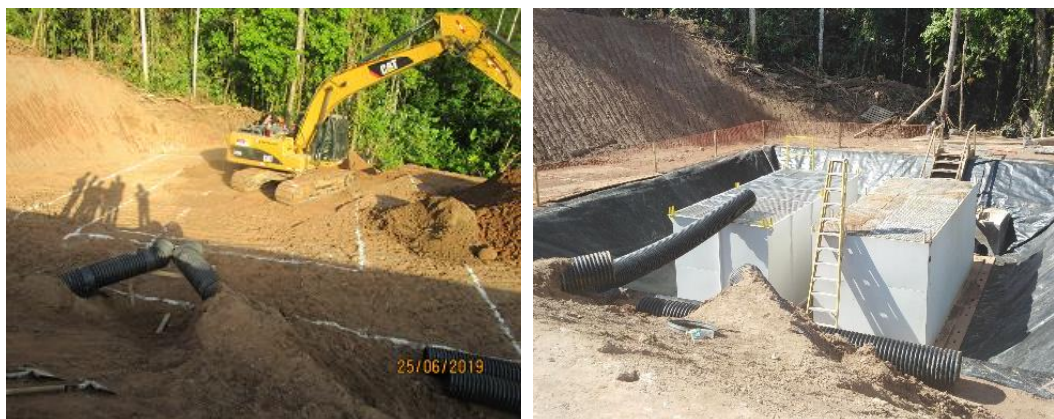
Anexo A.1.50. Fosa de Skimmer y Recepción de Aguas de Canales
