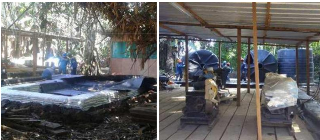
Anexo A.1.82. Estación de Bombeo
