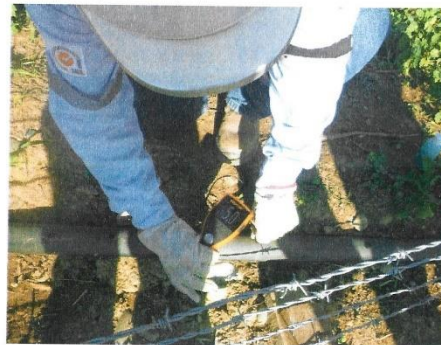
Foto 5: Medición de Espesor de tubería HDPE 2" con Equipo UT, resultado prom.: 5.0mm. Lado MA1006
