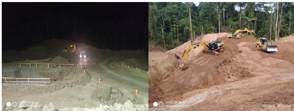
Anexo A.1.27. Corte y Relleno Masivo – Sector A-8 – Trabajo Diurno y Nocturno
