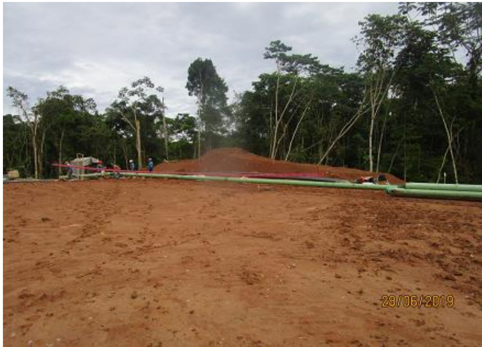
Anexo A.1.56. Tendido y Trabajos de Soldadura y Revestimiento de Juntos de Tuberías de Acero
