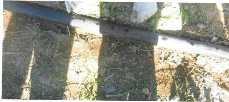
Foto 1: Superficie liza correcta para la medición por UT
