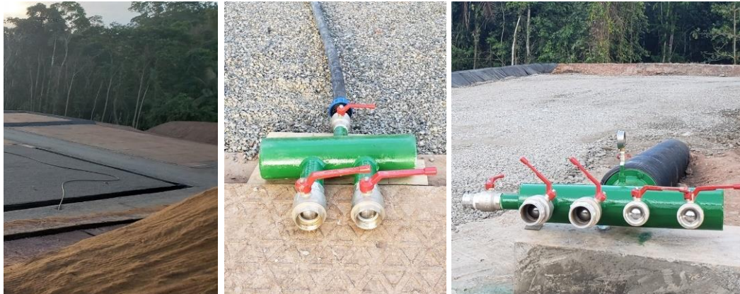
Anexo A.1.85. Llegadas a Plataforma
