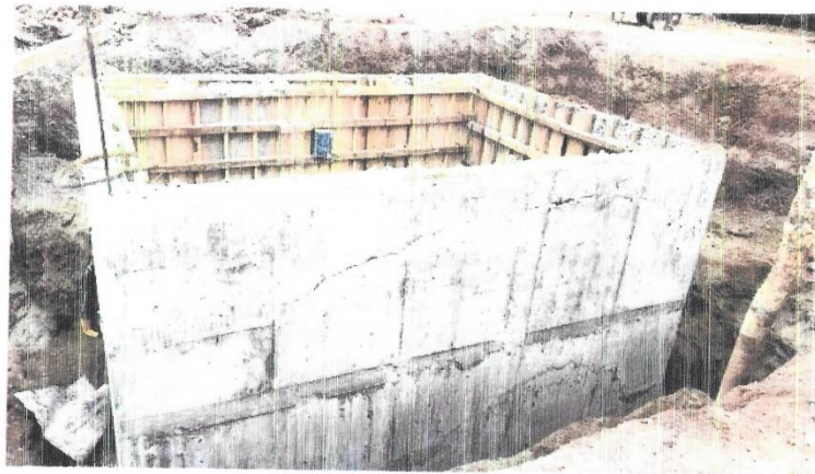
Foto 1. Juntas frías en muro del cellar
