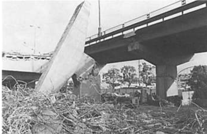
Figura 2.9. Falla por flexión-corte a la mitad de la altura de la columna del viaducto Route 43/2, debido a la terminación prematura del refuerzo longitudinal. Sismo de Kobe de 1995 (Priestley et al., 1996)
