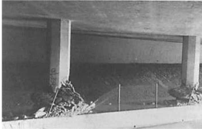
Figura 2.8. Rótulas plásticas por flexión en columnas restringidas por muro de conexión, en el puente sobre el canal Bull Creek Canyon. Sismo de Northridge de 1994 (Priestley et al., 1996)
