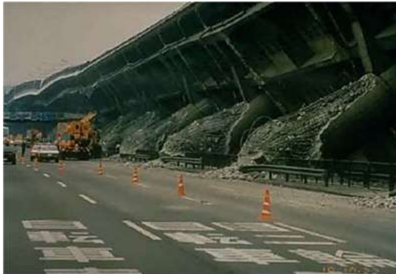
Figura 2.10. Falla por flexión debido a la terminación prematura del refuerzo longitudinal y al inadecuado confinamiento en las columnas de la autopista de Hanshin. (Sismo de Kobe, 1995)
