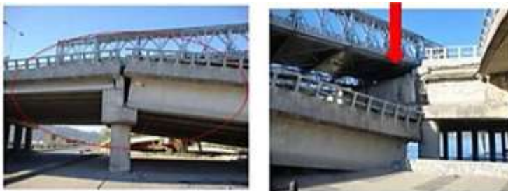
Figura 2.1. Colapso por mesa de apoyo insuficiente. (Sismo de Chile, 2010)
