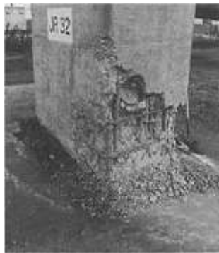
Figura 2.6. Falta en la base de la columna debido a la falta de longitud de empalme, sismo de Loma Prieta de 1989 (Priestley et al., 1996)
