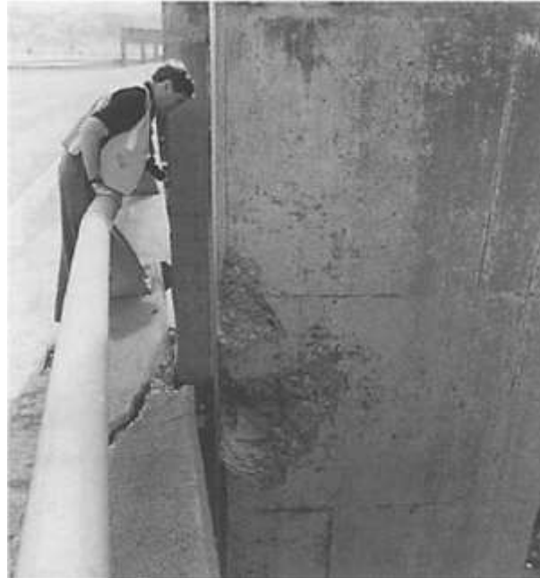
Figura 2.3. Golpeteo del Viaducto I-280 China Basin/Southern, Terremoto de Loma Pietra de 1989 (Priestley et al., 1996)
