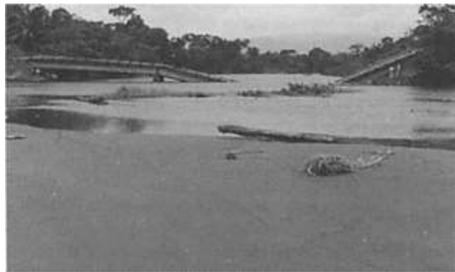
Figura 2.2. Falla por licuefacción. Puente sobre el río Vizcaya. Sismo de 1990 en Costa Rica. (Priestley et al., 1996)
