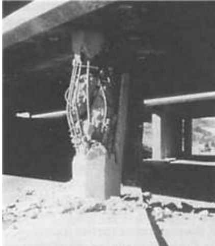
Figura 2.11. Falla por corte fuera de la región plástica. Sismo de San Fernando de 1971 (Priestley et al., 1996)
