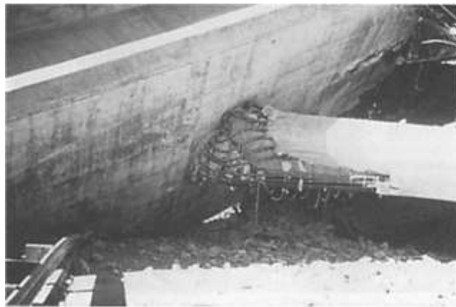
Figura 2.7. Falla en la parte superior de la columna por falta de confinamiento. Sismo de San Fernando de 1971 (Priestley et al., 1996)
