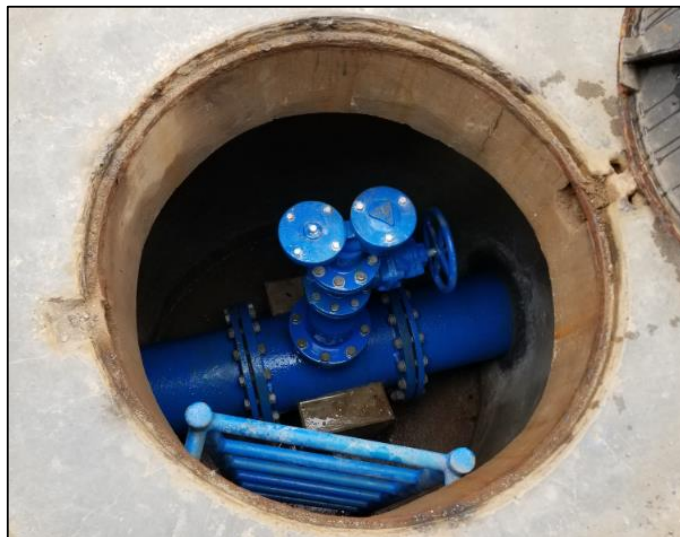
Figura 2.36 Cámara de válvula de aire. Fuente: (EDP, 2024).
