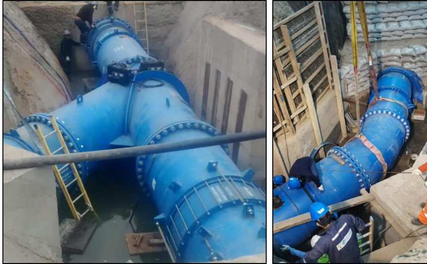
Figura 2.8 Obras de conducción de la Línea Atarjea Centro de DN1400mm-HD (ubicado en la av. 28 de Julio). Fuente: (Equipo Distribución Primaria [EDP] de SEDAPAL, 2022).
