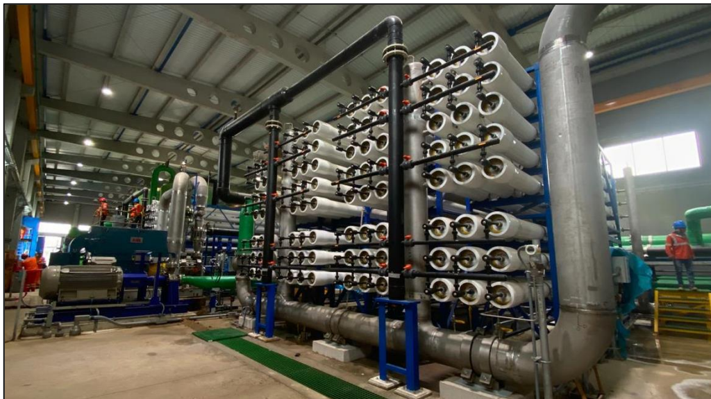
Figura 2.7 Proceso de ósmosis inversa de la Instalación Desaladora de Agua de Mar PROVISUR (IDAM PROVISUR). Fuente: (Consortio ACUAMED – AQUATEC, 2020).
