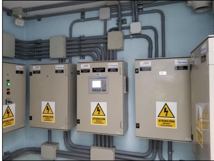
Figura 2.35 Tableros de la cámara SCADA. Fuente: (EDP, 2024).
