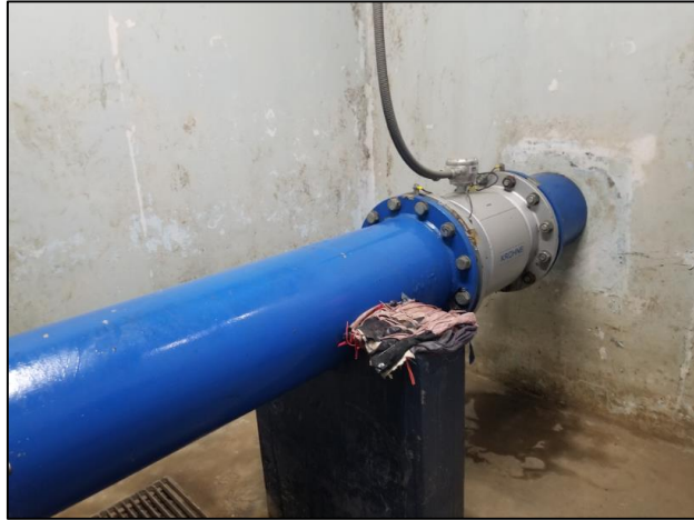
Figura 2.33 Medidor de caudal electromagnético de la cámara de medición. Fuente: (EDP, 2024).
