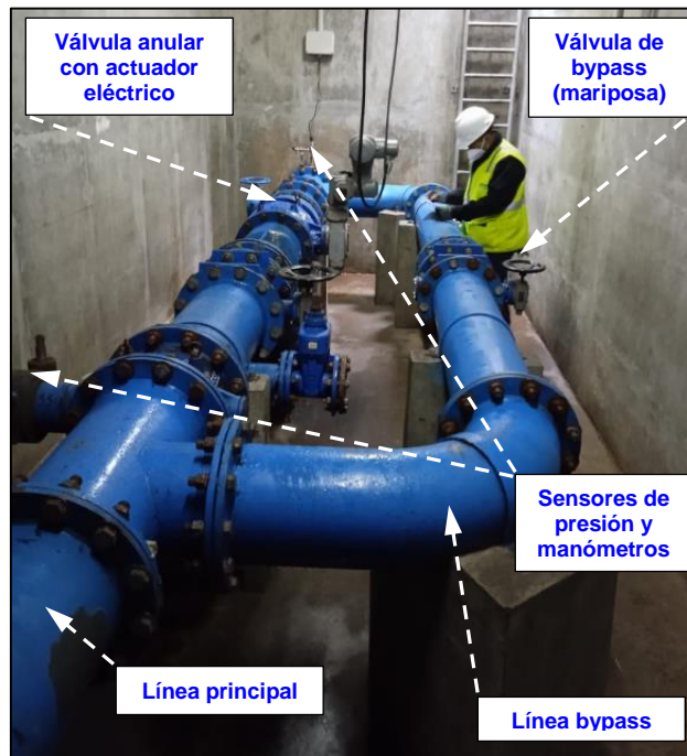
Figura 2.34 Instalaciones hidráulicas de la cámara de control. Fuente: (EDP, 2024).
