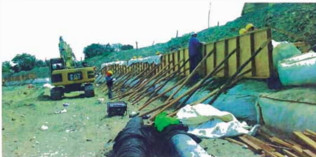
Figura N°3.16 Habilitado de encofrado para segundo nivel. Fuente, Cortesía de Andex del Norte.
