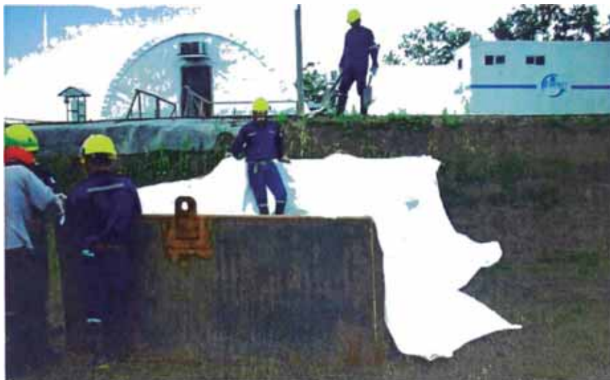
Figura N°3.10 Habilitado de geocontenedor vacío con encofrado metálico. Fuente, Cortesía de Andex del Norte.
