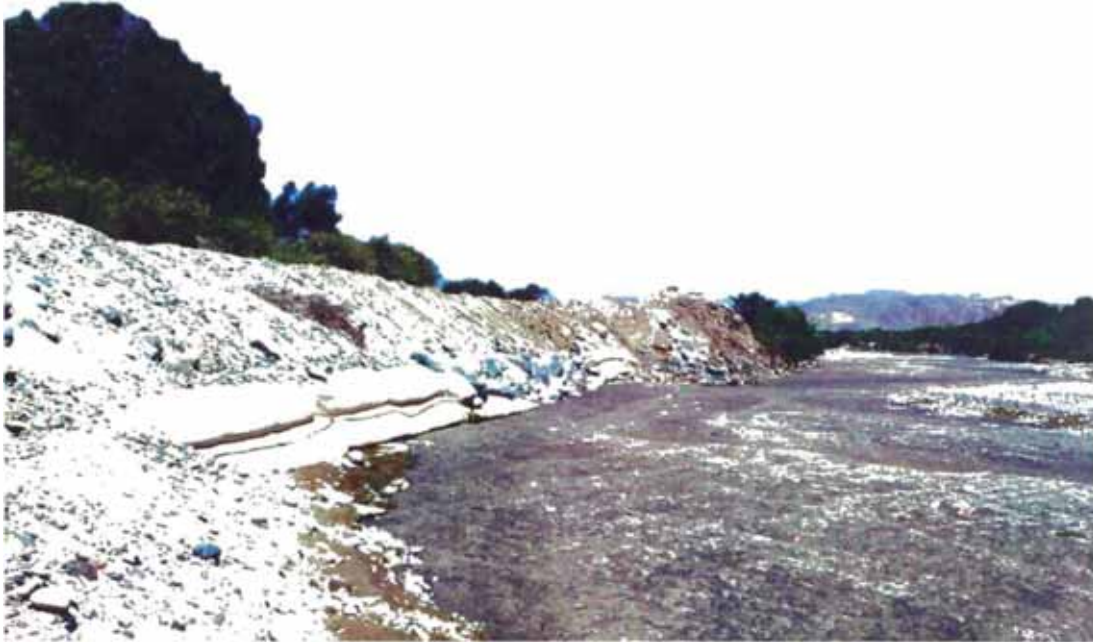
Figura N°4.7 Vista de la zona de hundimiento en el Tramo IV, Cortesía de Andex del Norte.
