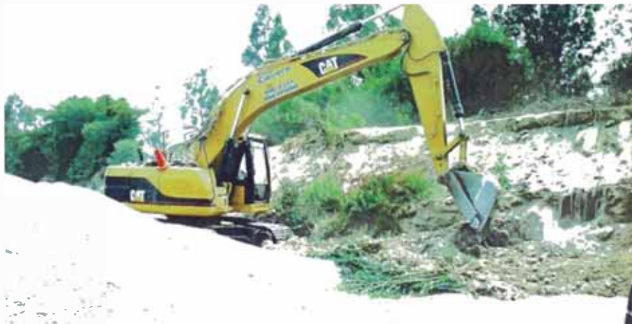
Figura N°3.7 Corte y limpieza de los taludes del río Ica. Fuente, Cortesía de Andex del Norte.
