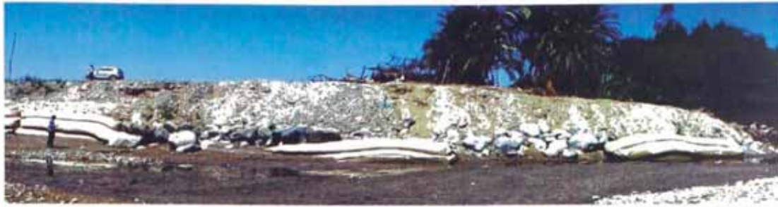
Figura N°4.4 Vista de la zona de hundimiento en el Tramo II, Cortesía de Andex del Norte.
