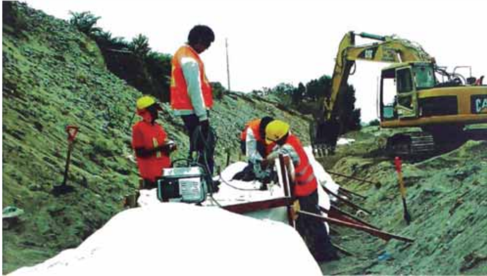
Figura N°3.14 Cierre de la tapa del geocontenedor con cocedora portátil. Fuente, Cortesía de Andex del Norte.
