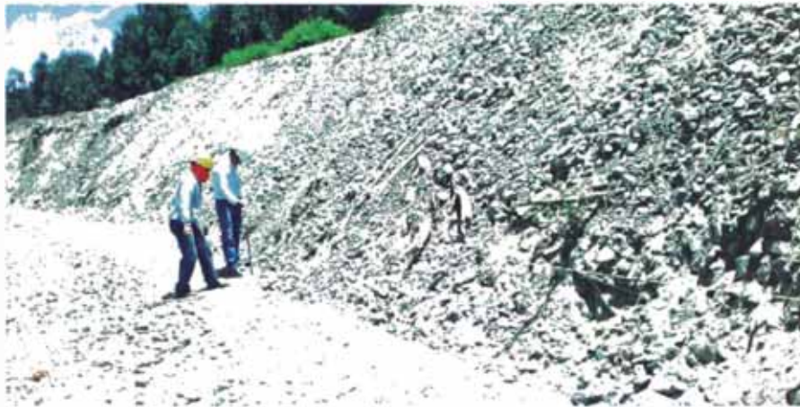
Figura N°3.8 Trazo del vértice del talud y talón del geocontenedor. Fuente, Cortesía de Andex del Norte.
