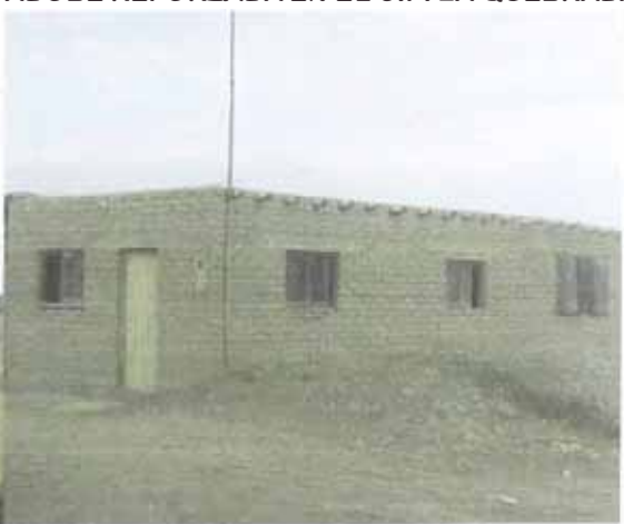
FIGURA Nº 2.20 VIVIENDA DE ADOBE EN REGULAR ESTADO EN EL C.P. SANTA CRUZ
