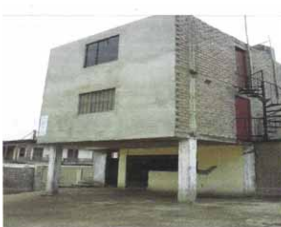
FIGURA N° 2.23 VIVIENDA DE ALBAÑILERÍA AFECTADA EN EL C.P. LAURA CALLER
