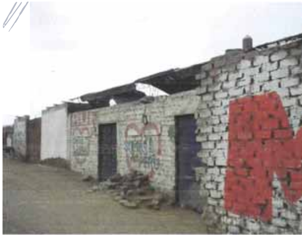
FIGURA Nº 2.17 VIVIENDA DE LADRILLO FISURADA EN EL C.P. SAN LUIS
