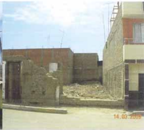
FIGURA Nº 2.04 VIVIENDA AFECTADA EN LA CAPITAL
