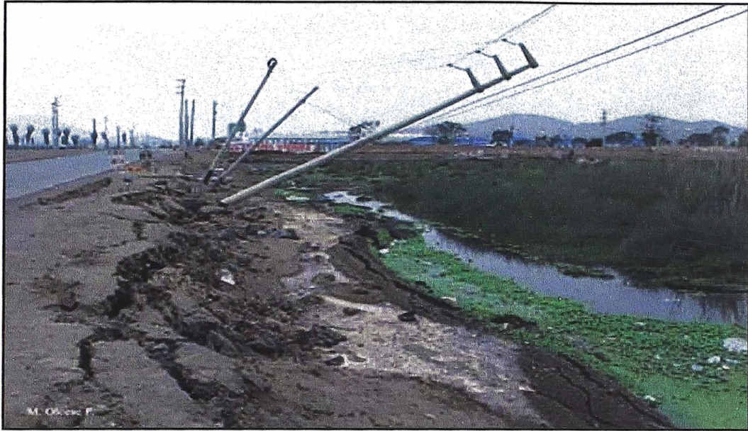
Fotografía N° 25: En obras de electrificación, la falta de un adecuado anclaje, hace vulnerables a los postes ante un sismo o inundación. Tomado en los pantanos de villa, en Chorrillos después del sismo del 2007.
