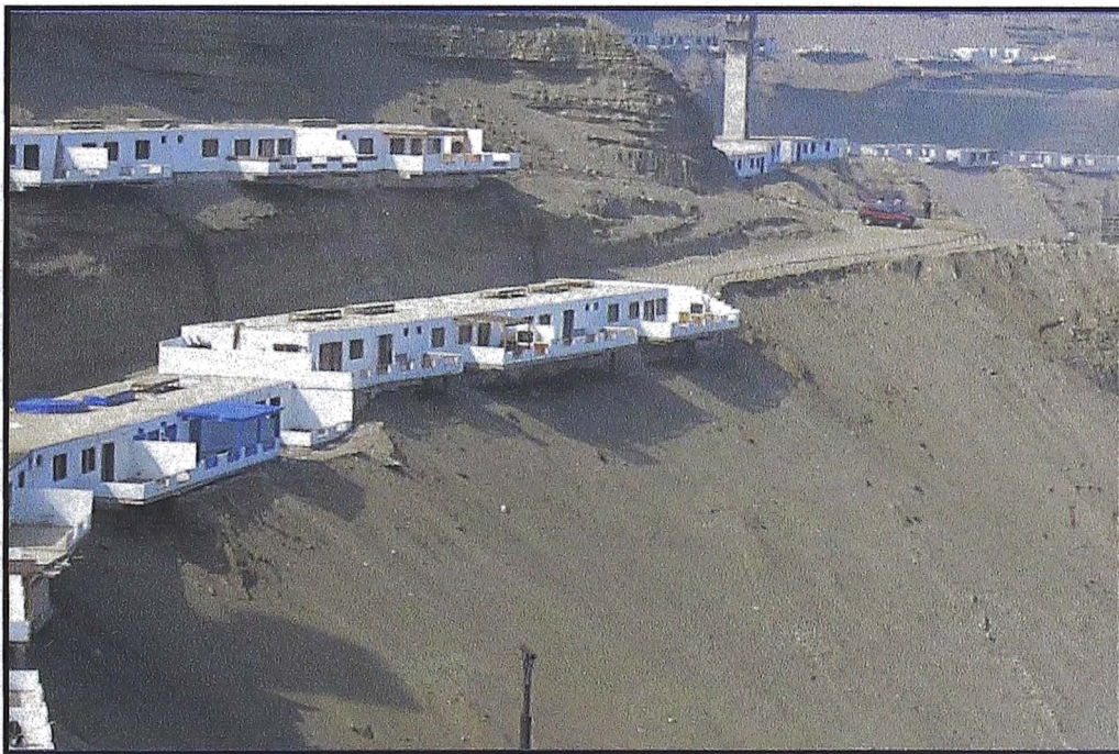
Fotografía N° 22: Cimentación en taludes arenosos de fuerte pendiente, tornando a las viviendas altamente vulnerables ante un sismo.
