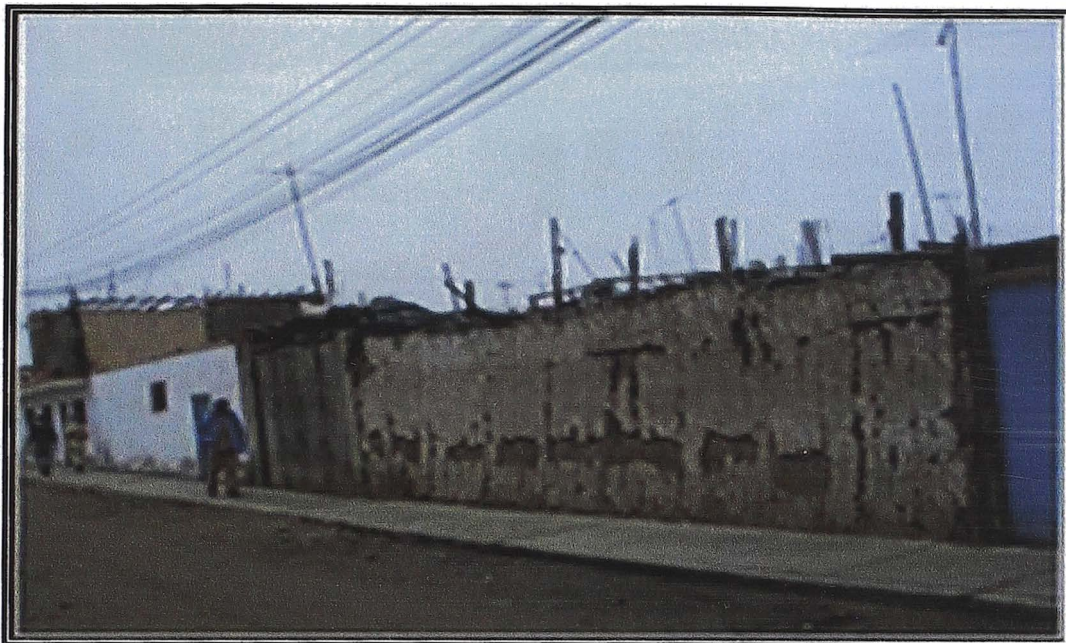
Fotografía N° 19: Viviendas de quincha en el centro urbano, con un deteriorado estado de conservación.
