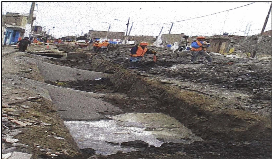
Fotografía N° 26: En obras de saneamiento, las tuberías y conexiones domiciliarias son las más vulnerables, sobre todo si cruzan suelos blandos.
