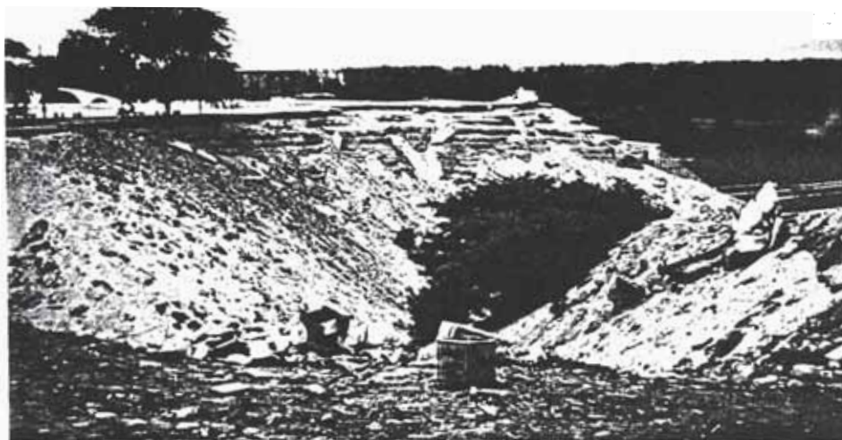
Foto 5.6: Cárcava de la Plaza Bolognesi, observar las capas de relleno mal compactado
