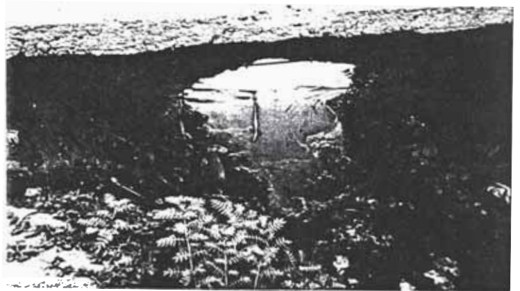
Foto 5.12: ENSO 1992, daños al Canal-Vía hechos por los pobladores para desagüar sus calles.
