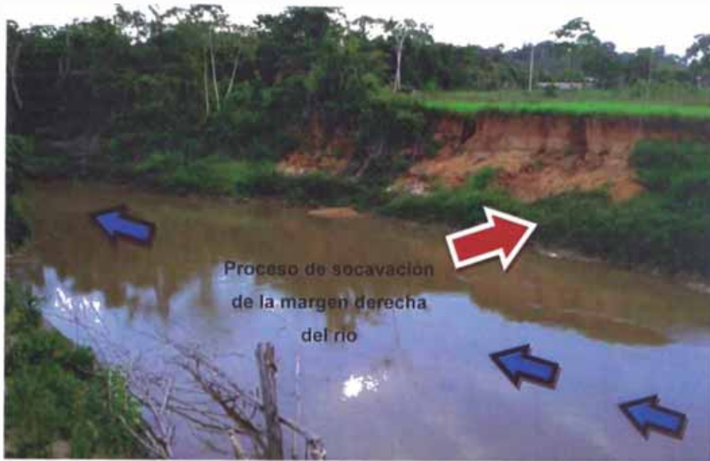
Foto N° 3.1 Proceso de socavación aguas arriba del puente Mavila (Dic. 2011)
