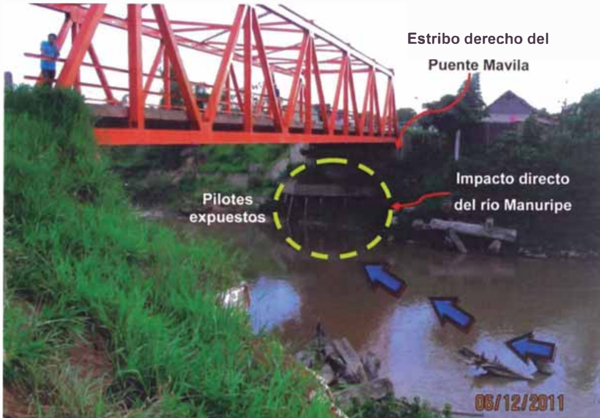
Foto N° 3.3 Pilotes expuestos del estribo derecho del puente Mavila
