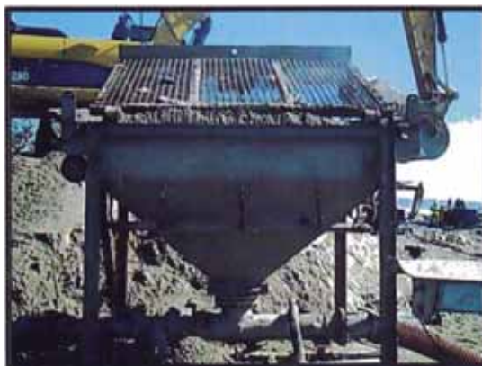
Figura N° 2.7.- En esta imagen se muestra la tolva y el sistema de tubería que alimenta a las geoestructuras.
