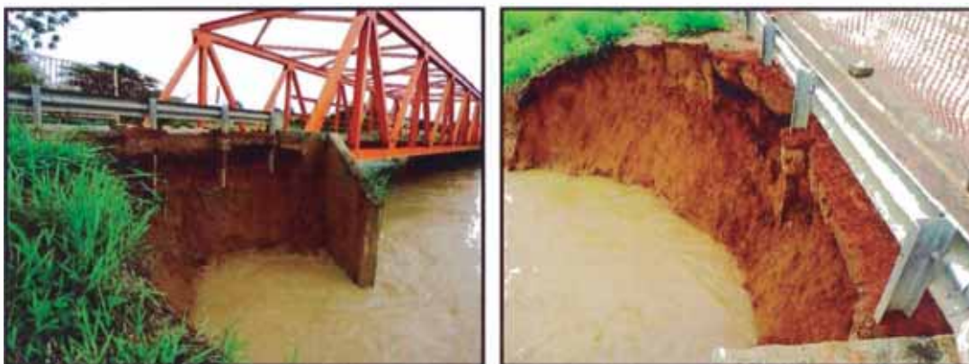
Figura N° 1.2.- Izquierda: Cavity originado por la erosión del río Manuripe. Derecha: Apoyos de la guardavía que se encuentran socavados.
