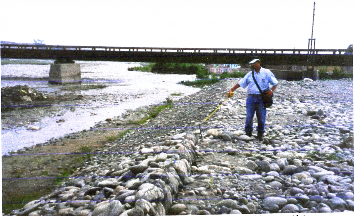
FOTO 10. Vista de la protección existente (parte de la cual ha sido sustraída)
