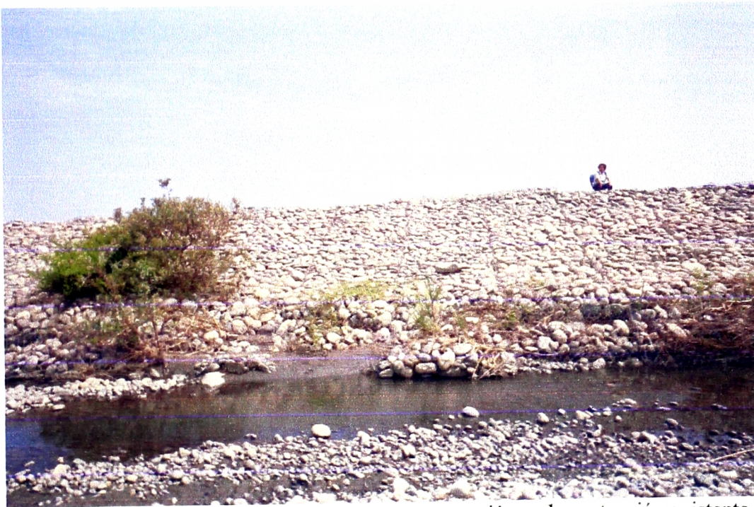
FOTO 12 Se puede observar como crece vegetación en la protección existente
