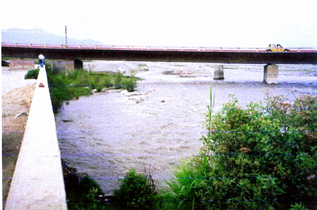
FOTO 15 Margen derecha del Río Pativilca aguas abajo del Punto Simón Bolívar , se puede observar el muro de contención que protege el Pueblo Joven Simón Bolívar.
