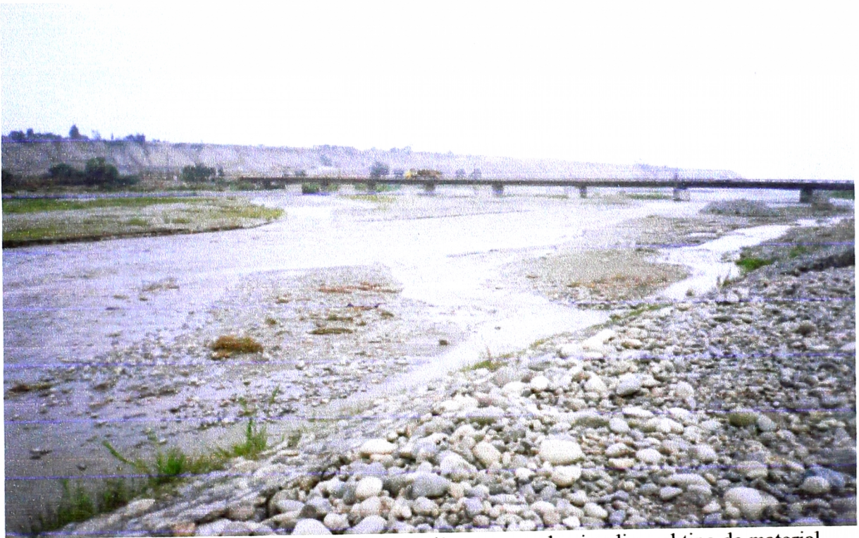
FOTO 08.- Aguas arriba del puente Simón Bolívar, se puede visualizar el tipo de material del Cauce para la estimación de coeficiente de Manning
