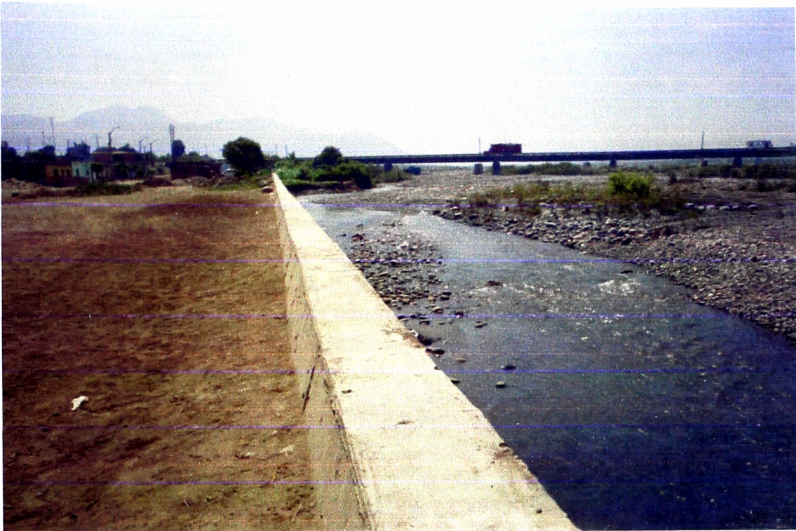
FOTO 17. Pueblo Joven Simón Bolívar – Aguas Abajo del Río Protección existente. Muro de Concreto.
