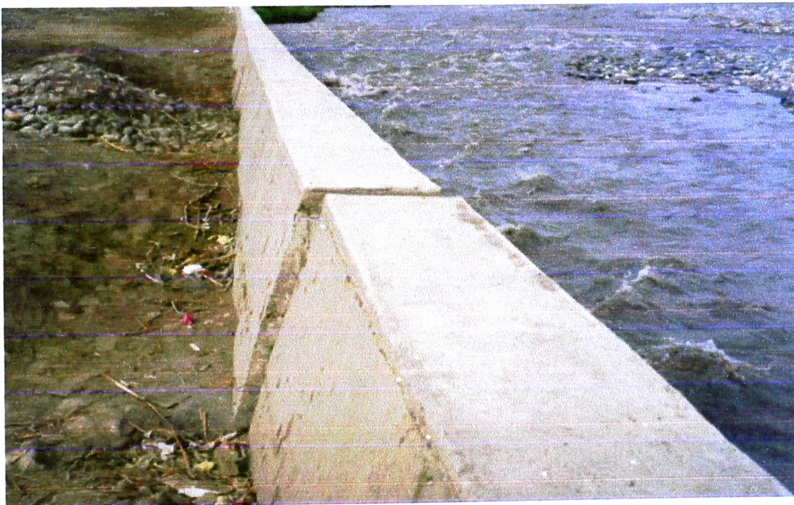
FOTO 18. Defensa existente, muestra signos de falla.
