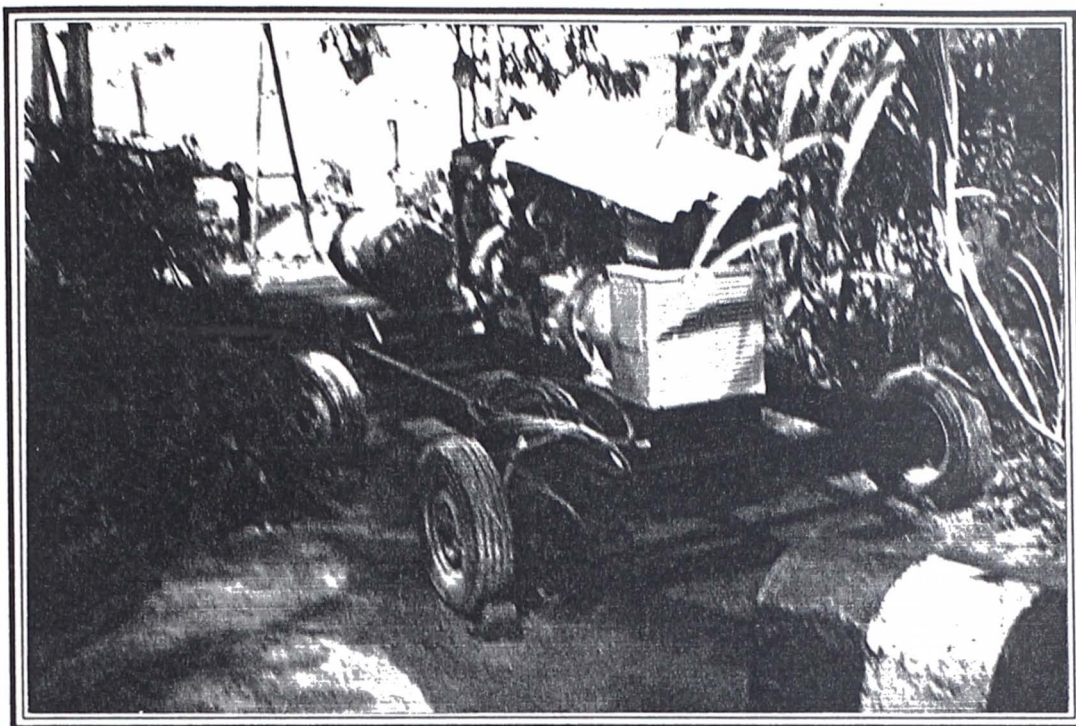
Foto 13 : Cámara de Bombeo de Desagües N°2: Esta caseta no cuenta con las estructuras adecuadas y como se aprecia, los equipos provisionalmente se encuentran protegidos por techos de calaminas. De ocurrir fuertes lluvias inunda todo este ambiente incluyendo la cámara húmeda.
