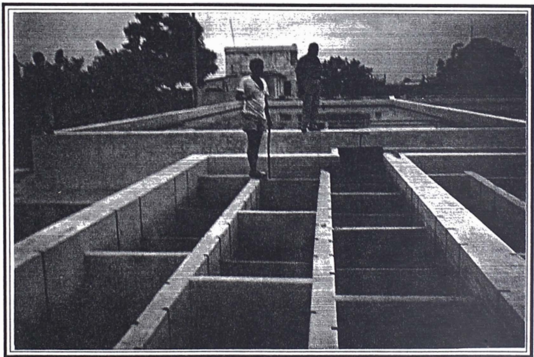
Foto 2: FLOCULADOR PLANTA NUEVA , vista de los compartimentos que conforman este floculador del tipo hidráulico. El ingreso es a través de una compuerta de hierro ubicada en el canal de ingreso.
