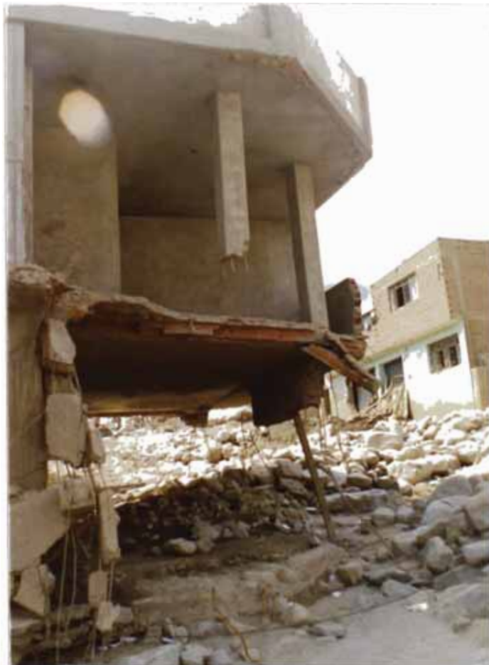
Foto 16: San Miguel de Pedregal. La vivienda quedó como voladizo, al perder sus columnas.
