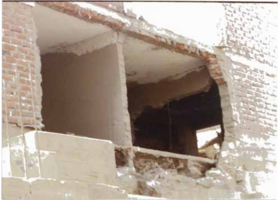
Foto 15: San Miguel de Pedregal. Tabiquería de segunda planta reventó, por el huayco.
