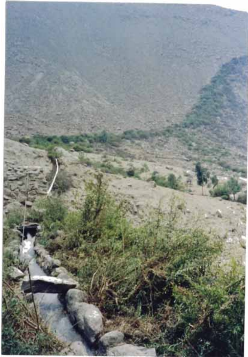
Foto 19: Quebrada Pedregal. Canal UTAPP. Pase del agua de la margen izquierda a la derecha. Obsérvese la vegetación que ha crecido por las filtraciones. Se trata de corregir el trazo de esta obra hidráulica.
