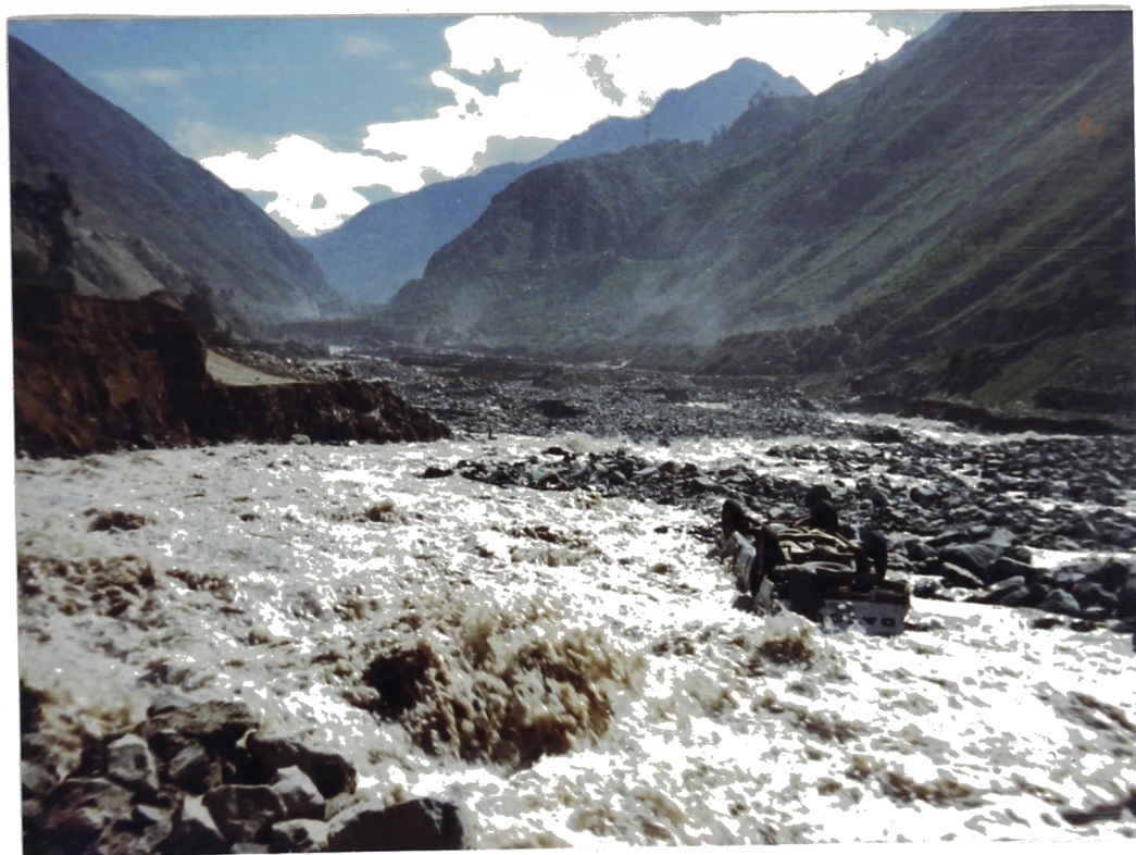
Foto N° 22. Km. 71+300 . Zona de Salón Blanco. La Carretera Central destruida, en un tramo de 200 metros, por el Río Rímac en la temporada de lluvias torrenciales de 1986 (Febrero). En la vista una camioneta destruida por el río y donde perecieron cuatro personas.
