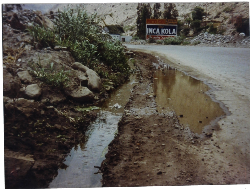
Foto N° 41. Km. 47+500. Otra zona de Corcona, parte baja, donde existe fuerte infiltración. La Carretera Central afectada.
