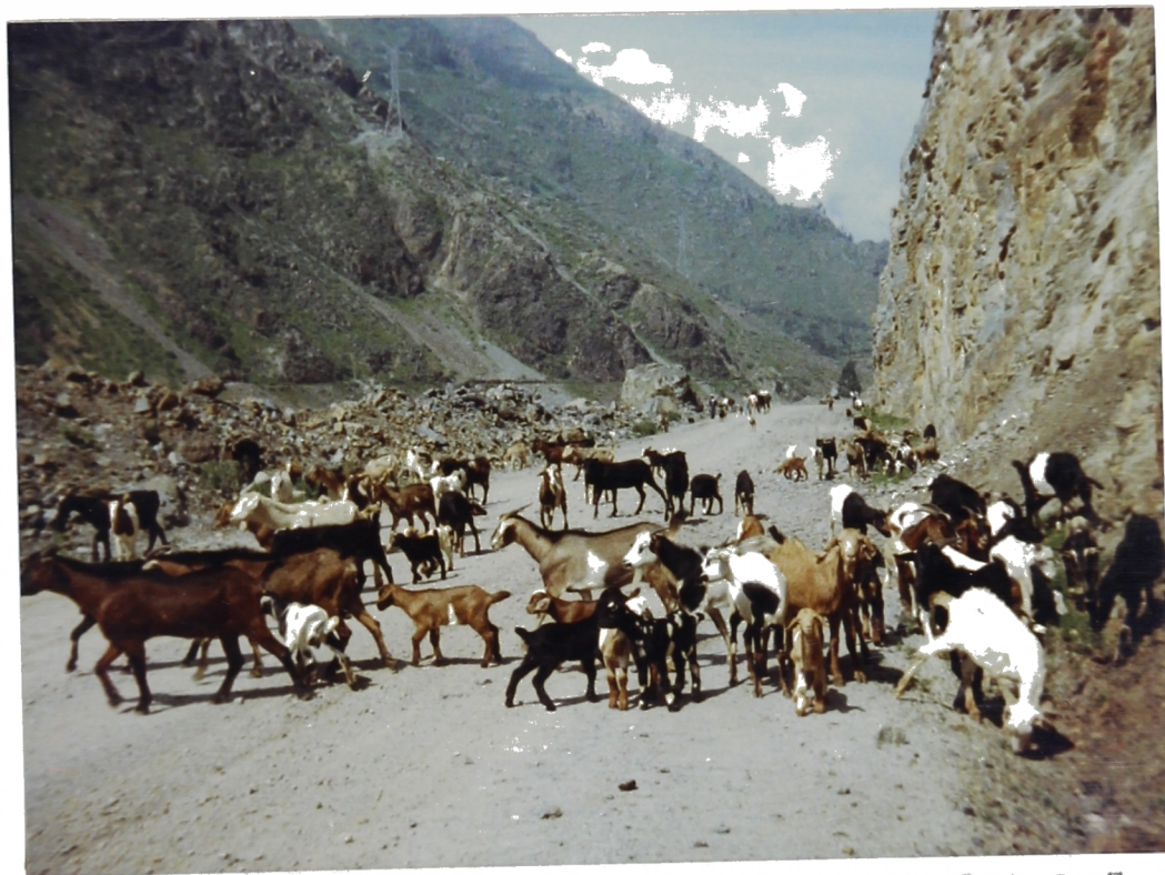
Foto N° 16. Km. 75+000. Una vista de la nueva Carretera Central, Tramo IV-C, que a más tardar debe ser concluida en Diciembre de 1986. Es zona de pastoreo de cabras.
