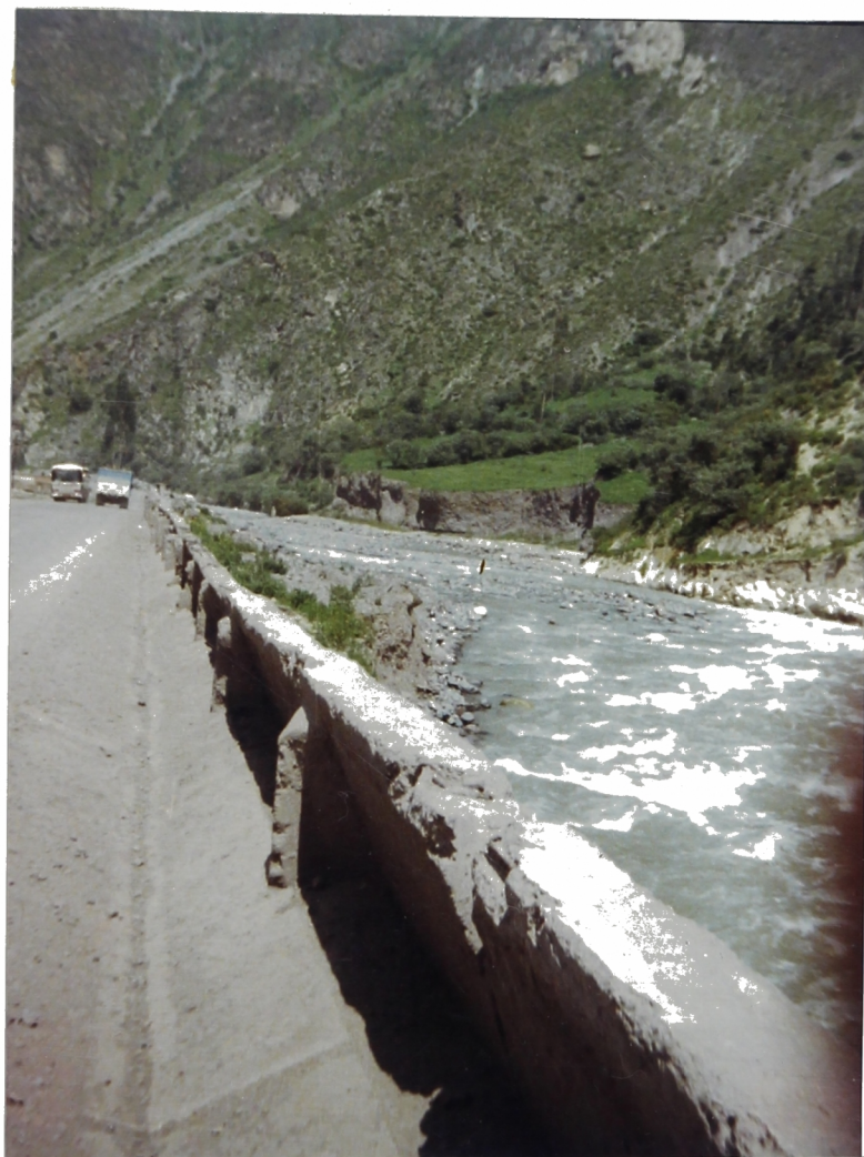
Foto N° 5. Km. 76+300 Muro de concreto subdimensionado afectado por la erosión que protege a Matucana.
