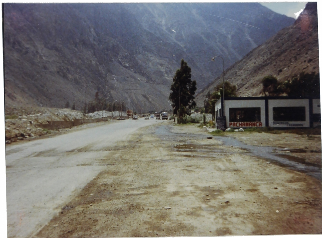
Foto N° 40. Km.47+900. Zona de Corcona. En la parte baja de Corcona existe fuerte infiltración. Al fondo el control de peaje, que fue enterrado por un huaco en 1984.
