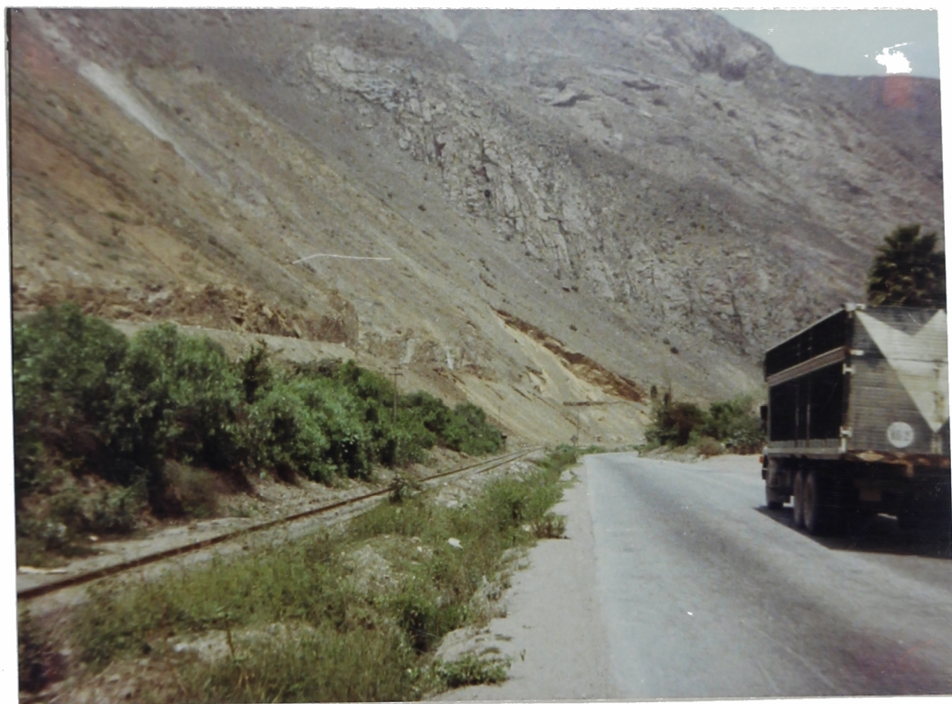
Foto N° 36. Km. 50+400 . Zona de Carachacra. Suelo coluvial de material friccionante amenazan la nueva Carretera Central (Tramo I)
