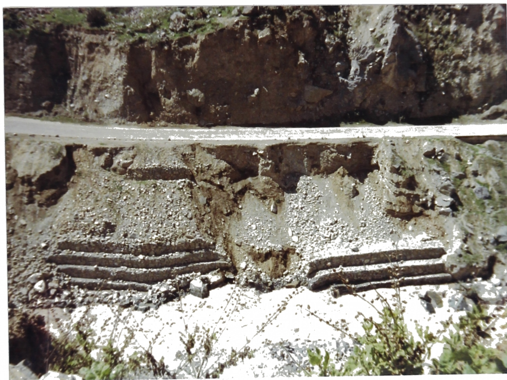
Foto N° 10. Km. 73+800 . Sector del Poblado de Huariquiña, el gavión escalonado que protegía el talud inferior de la Carretera Central fue destruido por el Río Rímac en Febrero de 1986.
