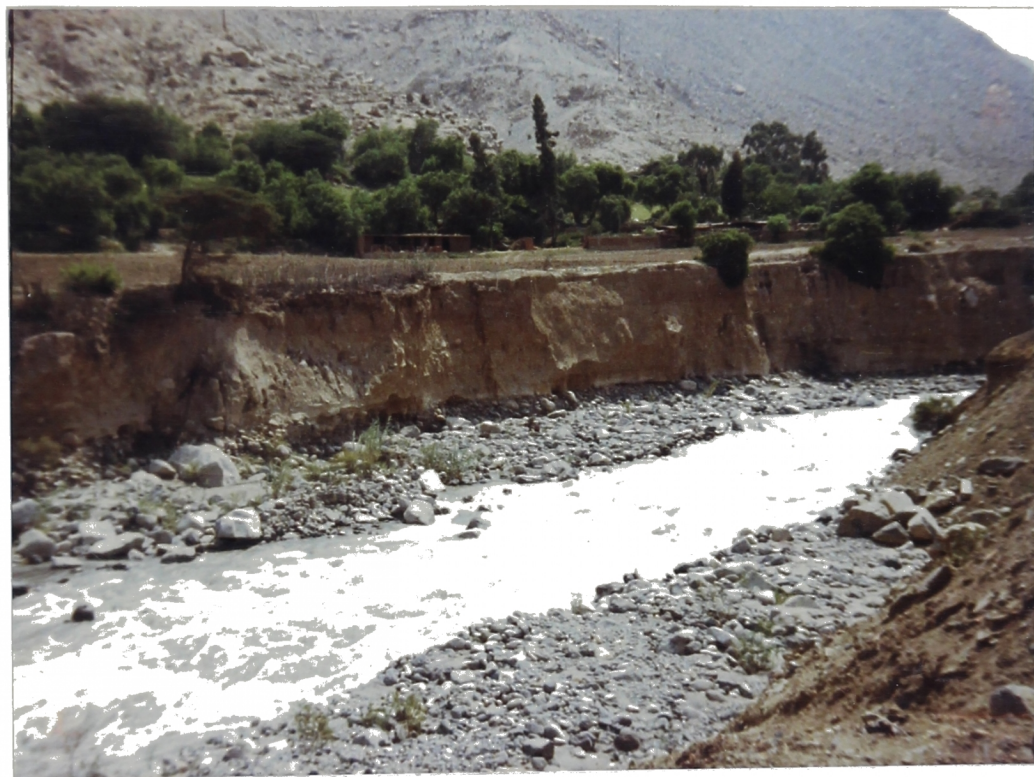
Foto N° 51. Km. 44+000. Zona rural de Cupiche. El Río Rímac destruye por erosión tierras de cultivo, disminuyendo la frontera agrícola.
