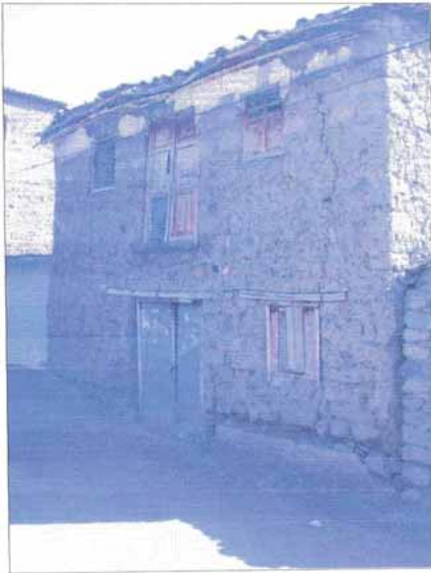
Figura 6.32: Construcción de adobe en mal estado de conservación.
