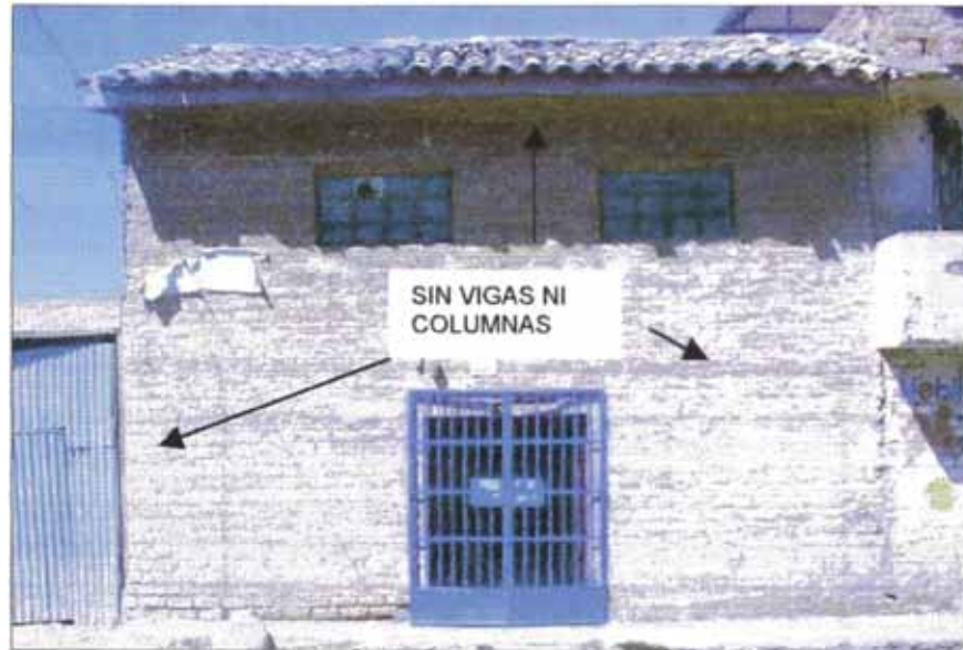
Figura 6.1: Albañilería sin ningún arriostramiento ni confinamiento de muros
