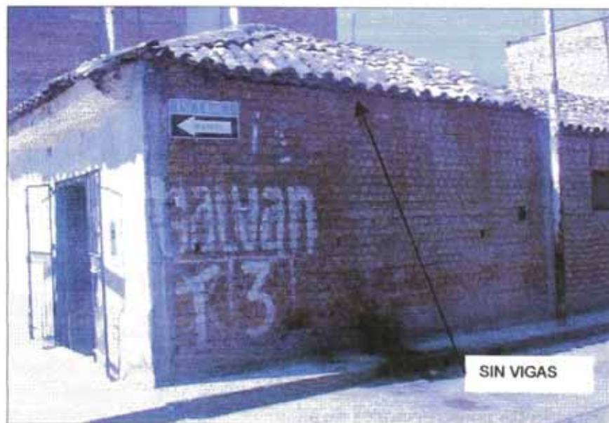
Figura 6.2: Albañilería con columnas pero sin vigas de confinamiento
