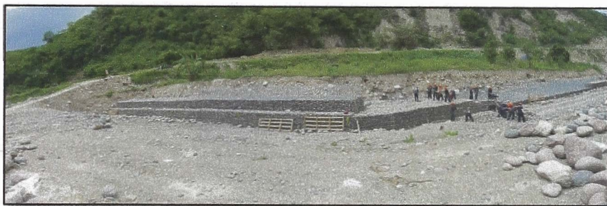
Fotos 6, 7 y 8: Muro de Gaviones y Muro de Concreto con Enrocado de Protección SDT 2779-278, abajo ejecución de gaviones en frente subcontratado.
