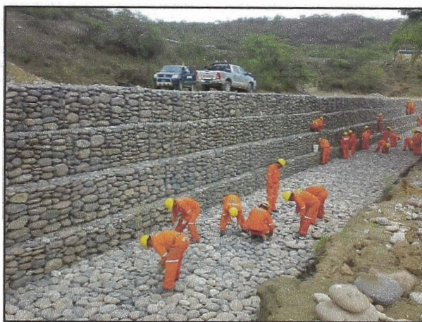
Fotos 1, 2 y 3: Muro de Gaviones culminado y ejecución de Enrocado de Protección, en la última colocación de Colchón de Gaviones – SDT3-322/323.
