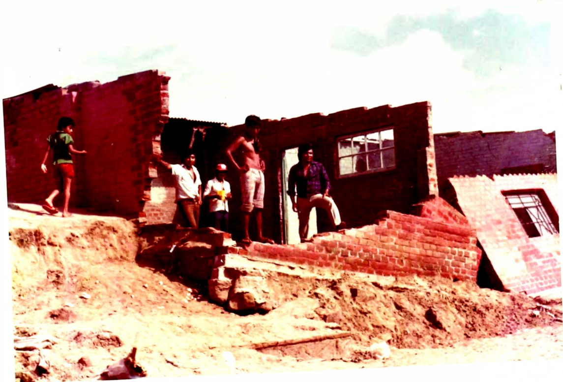
FOTO # 06: SOCAVAMIENTO DE LAS CIMENTACIONES DE EDIFICACIONES DE JESUS MARIA QUE PRODUJO DERRUMBE DE PAREDES
